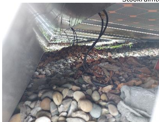
Bekabeling onder zonnepanelen
