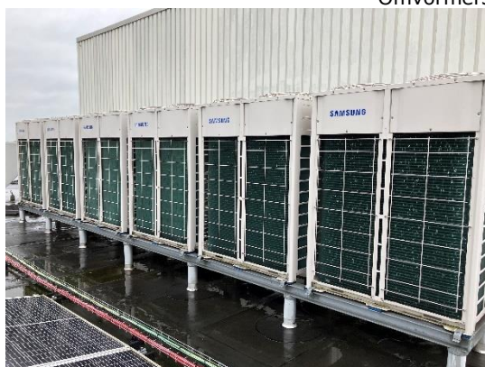
Buitenunits t.b.v. warmtepompen
