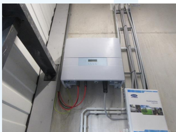
Aanzicht omvormer in technische ruimte in dakopbouw van gebouw 3
