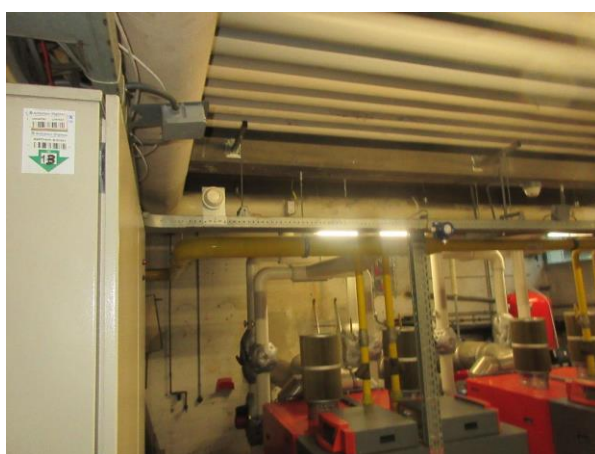
Inkijk ketelhuis in gebouw 1
