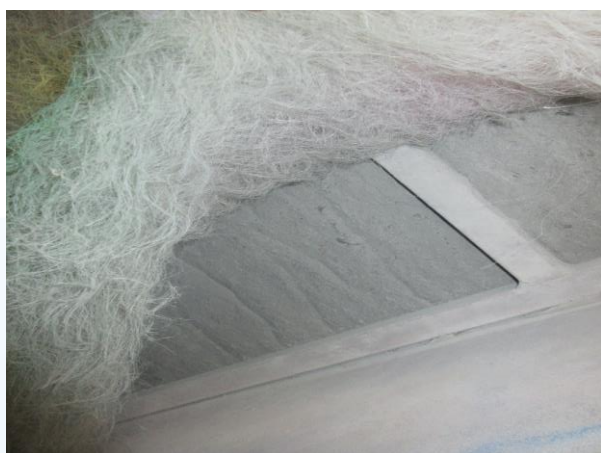
Aanzicht vervuilde filters spuitwand
