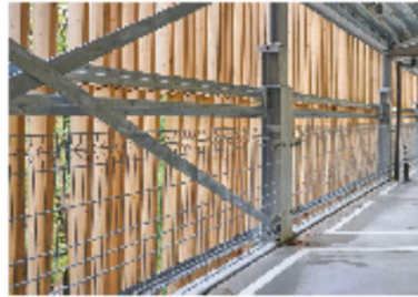
Verzinkt dubbelstaalnet als veiligheidsoplossing op parkeervloeren. Bevestigd aan de hoofdconstructie van de parkeerverdieping, zonder tussenpalen.
