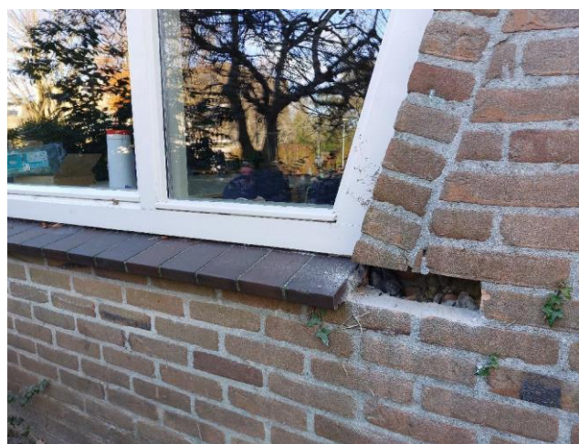
Onder de 'V'-vormige kozijnen is een kunststof flap in de spouw aangetroffen
