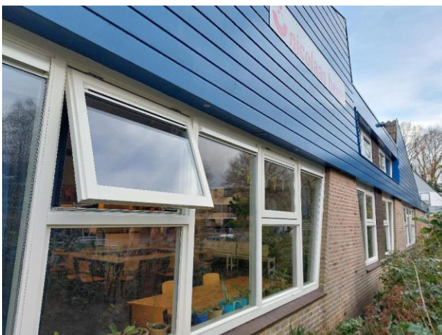
Kozijnen zijn van hout, boeidelen zijn van hout, lekdorpels zijn getegeld. Tussen de kozijnen en het metselwerk is geen kit toegepast.
