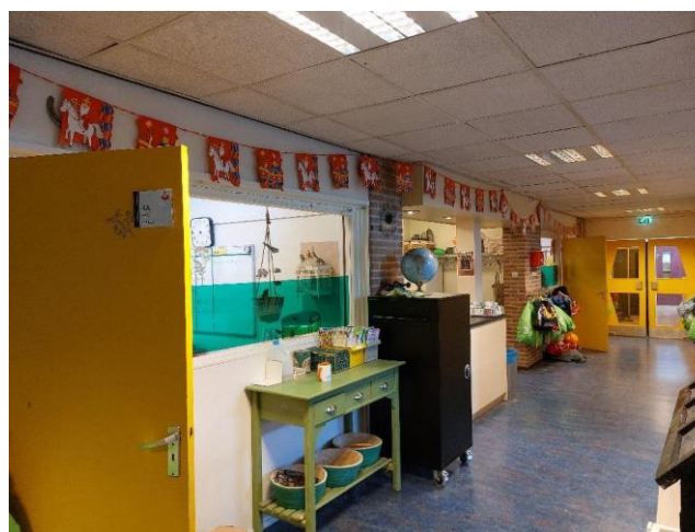
Het glas in lokaal 4a en 4b is vastgezet met schuimband
