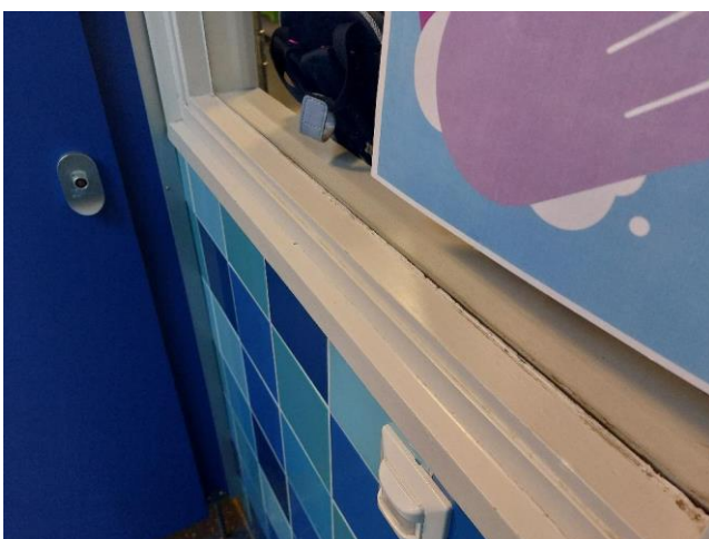
Het glas in de toiletruimtes is gekit met onverdachte kit met daar onder bron 7. het tegelwerk is modern.
