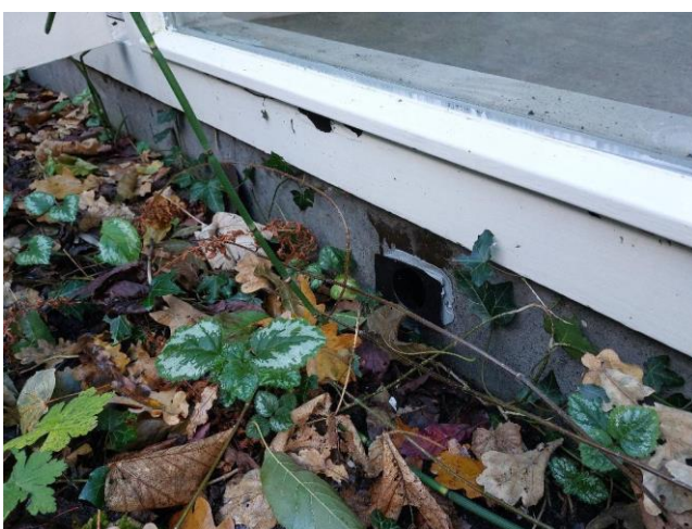
Flexibele onverdachte grijze kit is aangetroffen rond een afvoer in de kleine patio.
