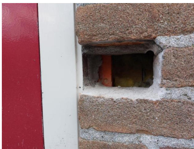
In de spouw is alleen glaswolisolatie aangetroffen
