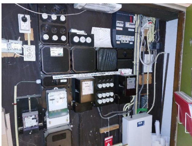
In de schakelkast zijn geen verdachte materialen
