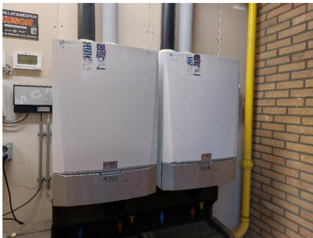
In de cv-ruimte (Nicolaas Beets) hangen twee onverdachte cv-ketels (Remeha, Quinta PRO)
