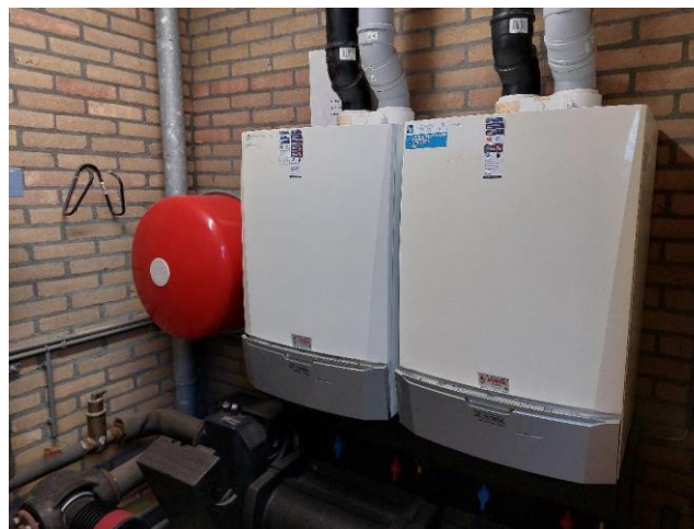
In de cv-ruimte (De Rank) hangen twee onverdachte cv-ketels (Remeha, Quinta PRO)
