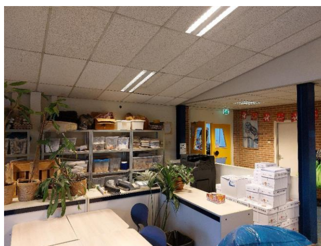
Metalen kolommen zijn niet omkleed
