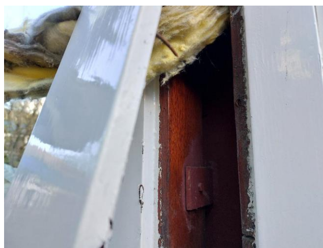
Achter de houten aftimmeringen t.p.v. de stalen kolommen is alleen glaswol aangebracht.
