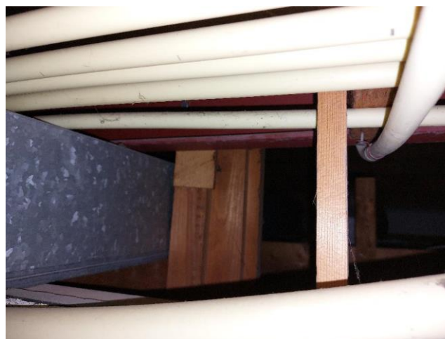
Ventilatiekanalen boven de verlaagde plafonds zijn niet voorzien van verdachte kit.
