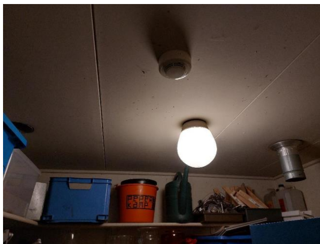
Ontluchting in de werkkast is van pvc en blik
