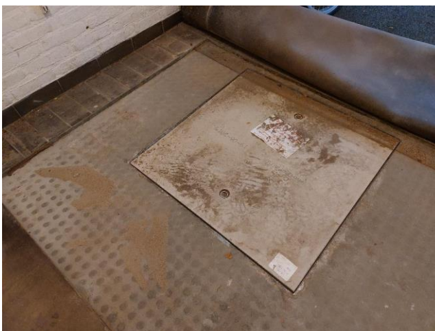
Het kruipluik komt uit 2015 en is daardoor onverdacht
