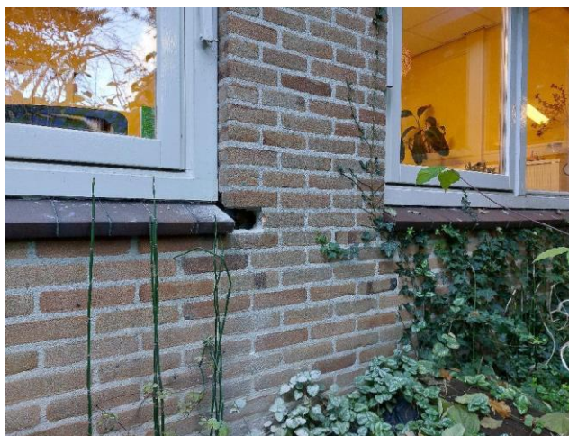
T.p.v de enkele kozijnen is aan de onderzijde een kunststof flap in de spouw toegepast.
