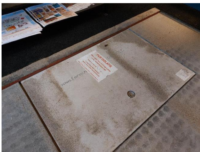
Het kruipluik in de gang komt uit 2015 en is daardoor onverdacht
