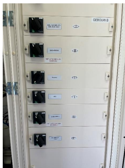
Figuur 4.2.2 1 reservegroep Gebouw B
