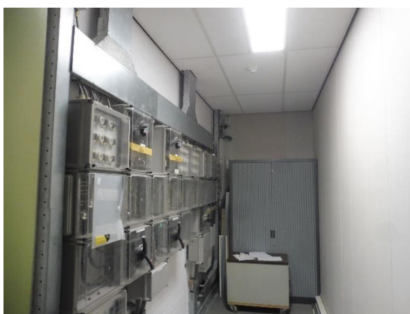
Gebouw 1: inkijk in de laagspanning-verdeelruimte.
