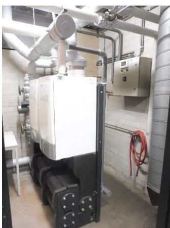
Gebouw 1: inkijk in de stookruimte.
