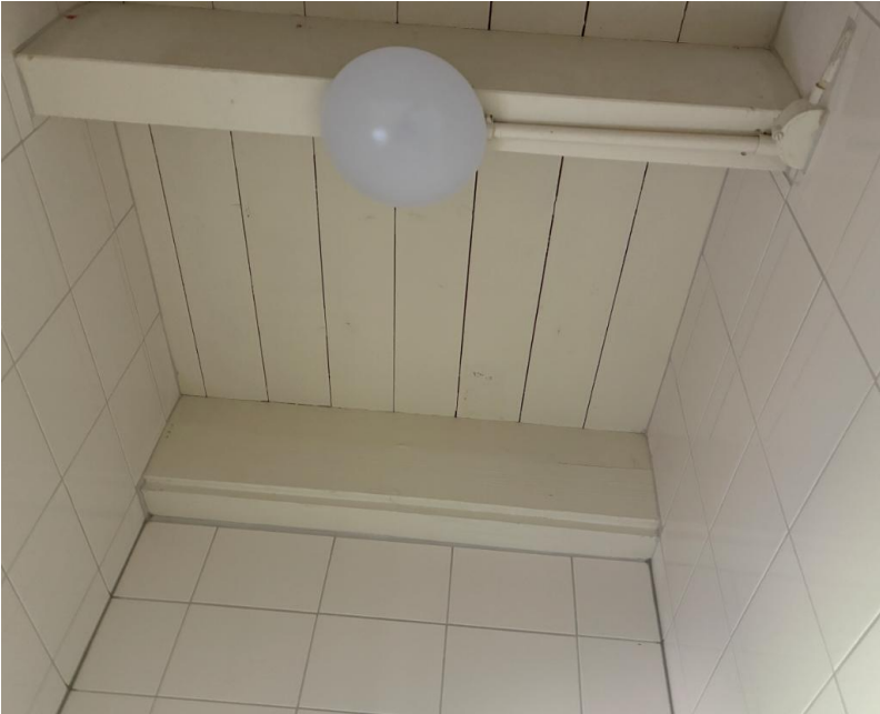
Foto 74: Foto armatuur in toilet Dienstgebouw begraafplaats Waspik
