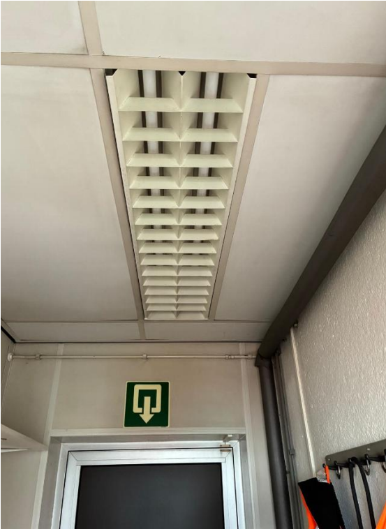
Foto 52: Detailfoto 1 inbouw TI-armatuur in kantoren Milieustraat Waalwijk
