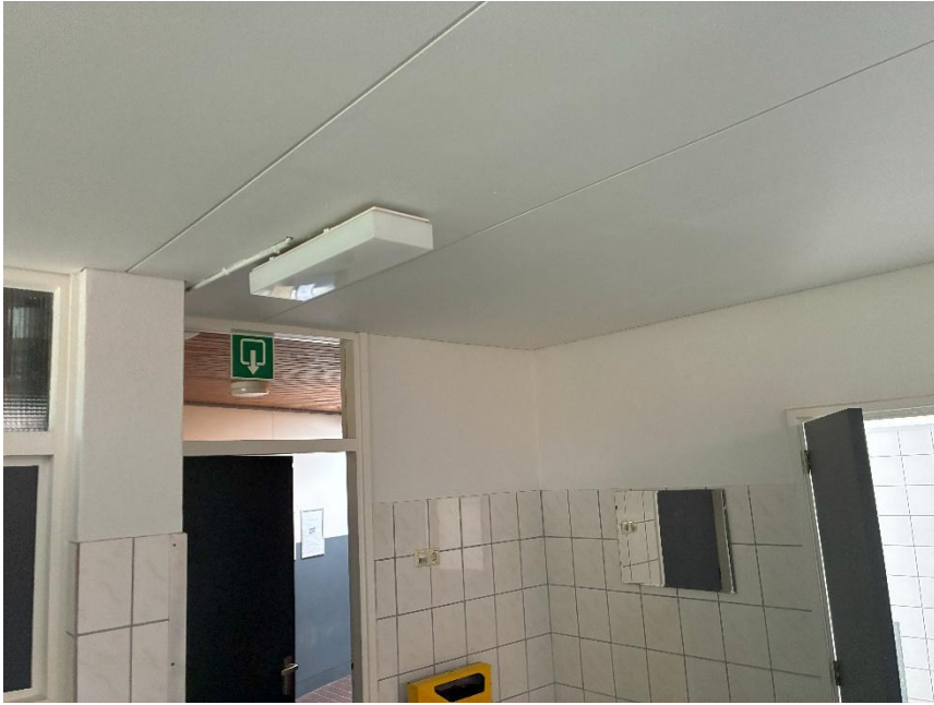
Foto 3: Foto 2 verlichting kleedkamer Gymzaal Wijnruitstraat
