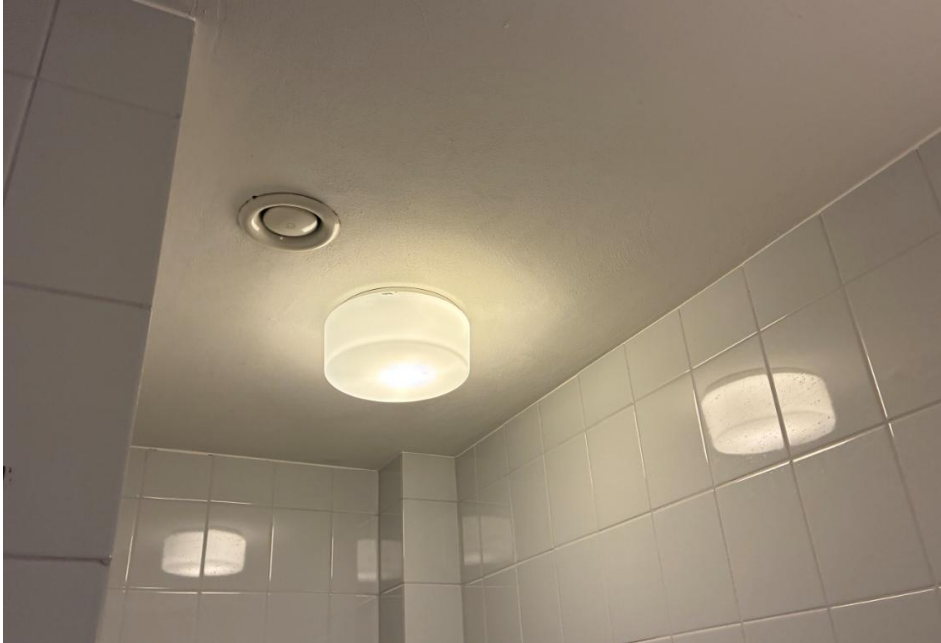
Foto 65: Overzichtsfoto van armaturen in toiletten Aula begraafplaats Sprang
