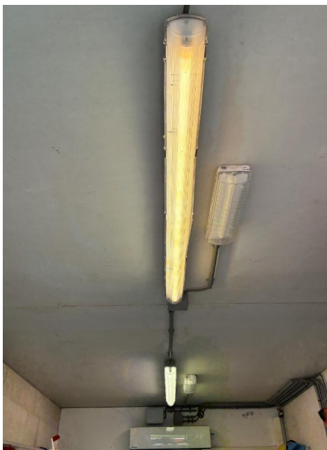
Foto 77: Overzichtsfoto van verlichting in laagspanningsruimte kantoor Sluis Waalwijk
