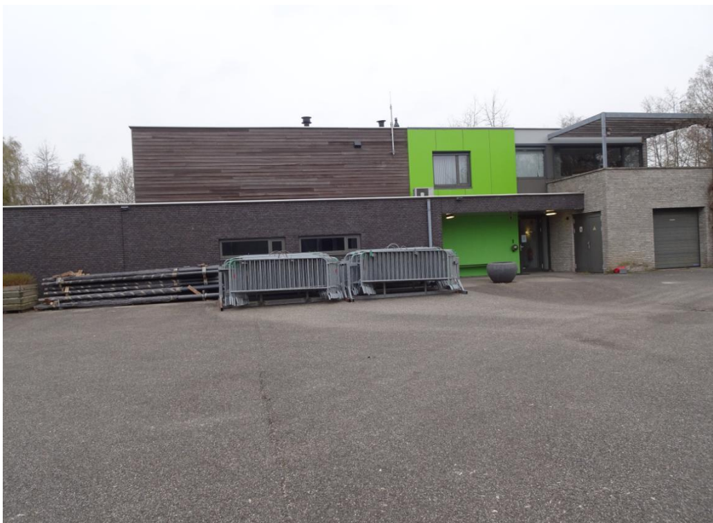
Foto 51: Overzichtsfoto van buitenverlichting luifel achterzijde Brandweerpost Sprang-Capelle
