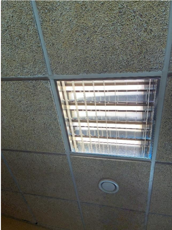
Foto 20: Foto van armatuur in kantoor-, vergader- en onderwijsruimtes Tavenu
