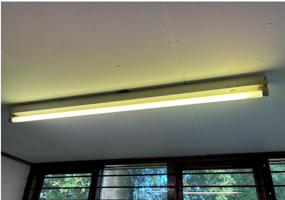
Foto 70: Overzichtsfoto van armatuur in kantoor Dienstgebouw begraafplaats Waalwijk
