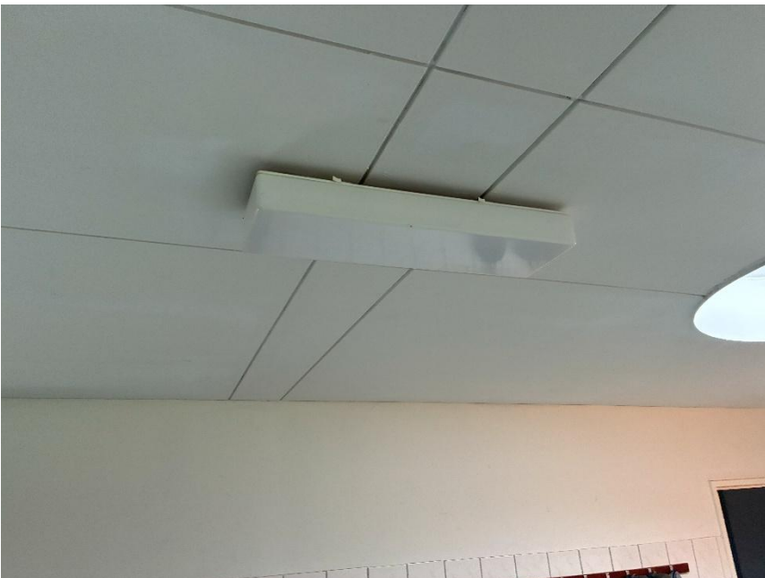
Foto 2: Foto 1 verlichting kleedkamer Gymzaal Wijnruitstraat
