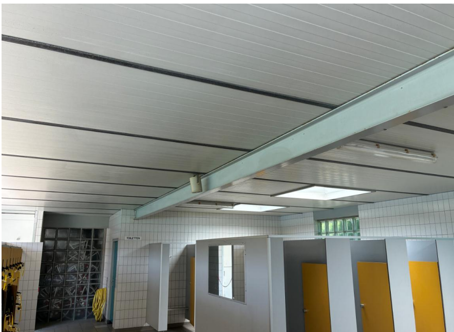
Foto 81: Overzichtsfoto armaturen kleedkamer 2 Openluchtwembad Zidewinde
