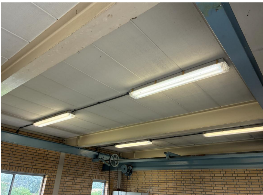
Foto 78: Overzichtsfoto van verlichting in pompruimte Sluis Waalwijk
