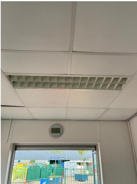
Foto 53: Detailfoto 2 inbouw TI-armatuur in kantoren Milieustraat Waalwijk
