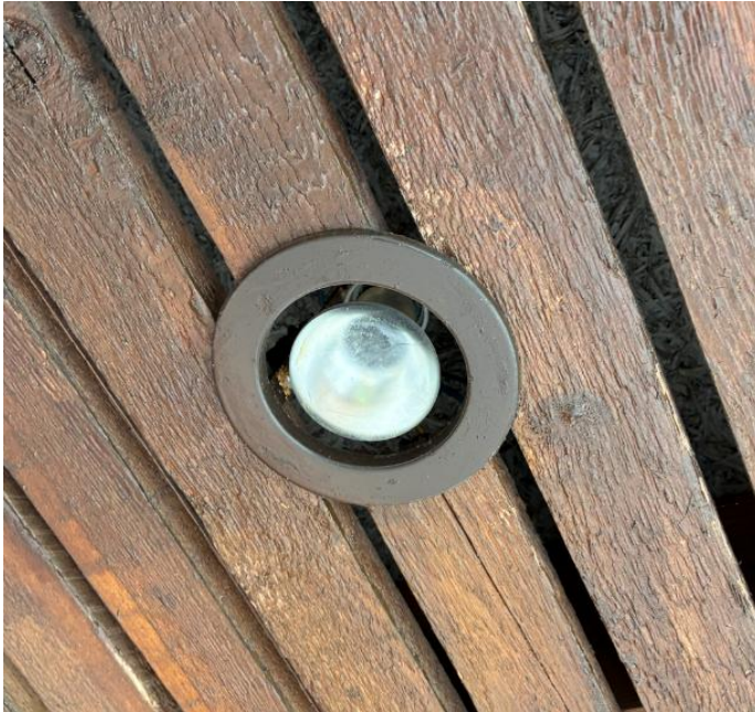
Foto 68: Detailfoto van armaturen onder luifel Dienstgebouw begraafplaats Waalwijk
