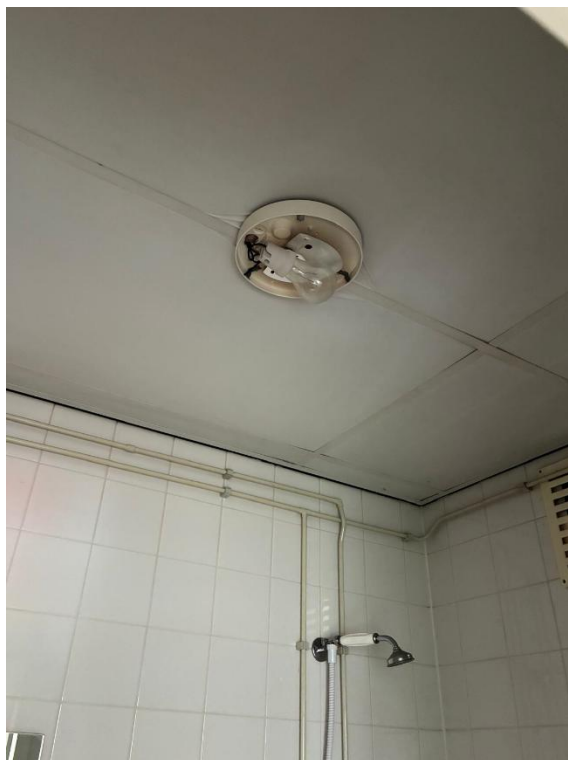
Foto 54: Overzichtsfoto E27 downlighter in sanitaire ruimte Milieustraat Waalwijk
