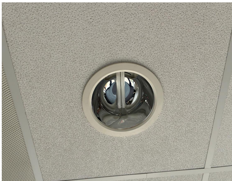
Foto 43: Detailfoto van inbouw PI-armatuur in kantoor Gemeentewerf Waalwijk
