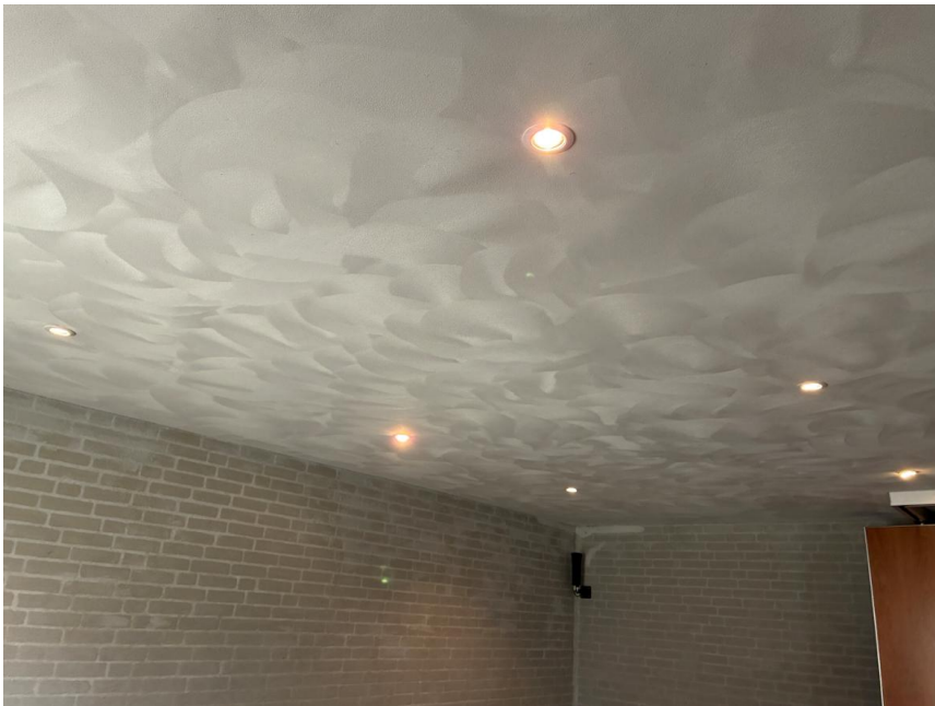
Foto 59: Overzichtsfoto van spots in plafond aula (ruimte 3) Aula begraafplaats Sprang
