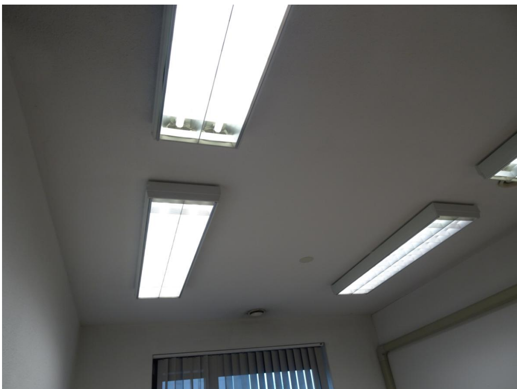
Foto 46: Overzichtsfoto van opbouw TI-armaturen in verblijfsruimtes Brandweerpost Sprang-Capelle
