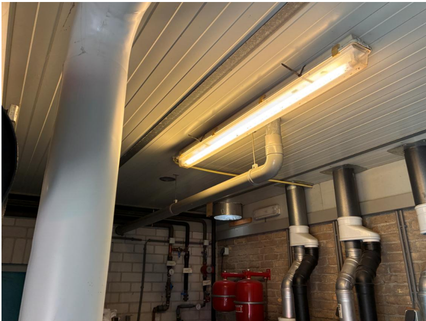
Foto 86: Foto van verlichting in de technische ruimte Openluchtwembad Zidewinde
