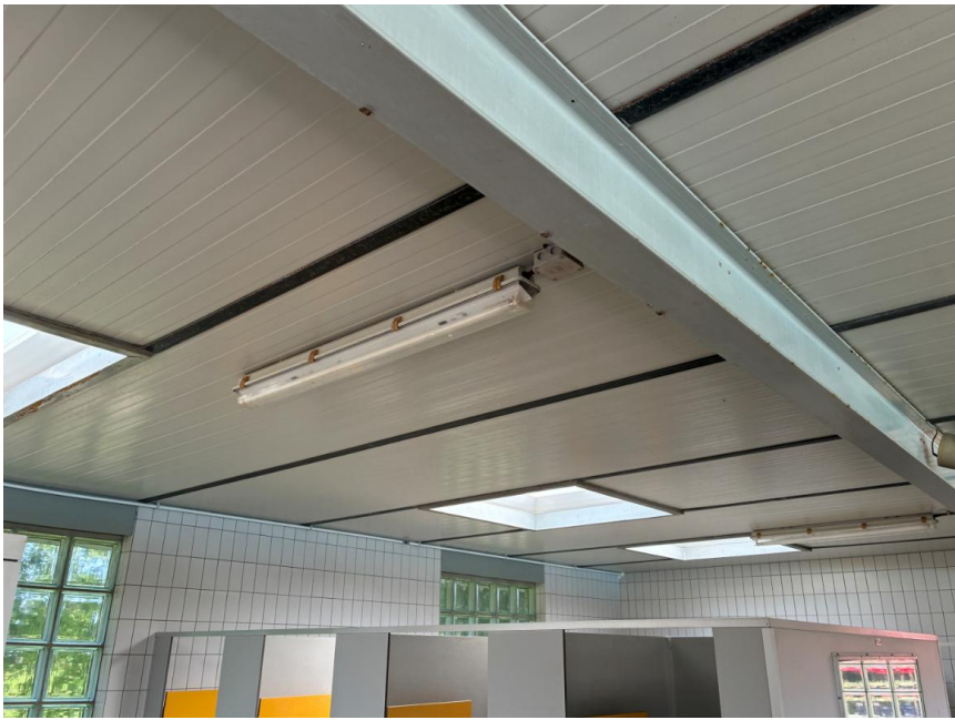
Foto 80: Overzichtsfoto armaturen kleedkamer 1 Openluchtwembad Zidewinde
