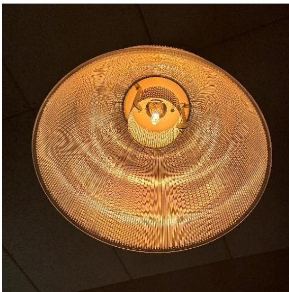
Foto 16: Detailfoto van pendelarmaturen in gangzone begane grond Tavenu
