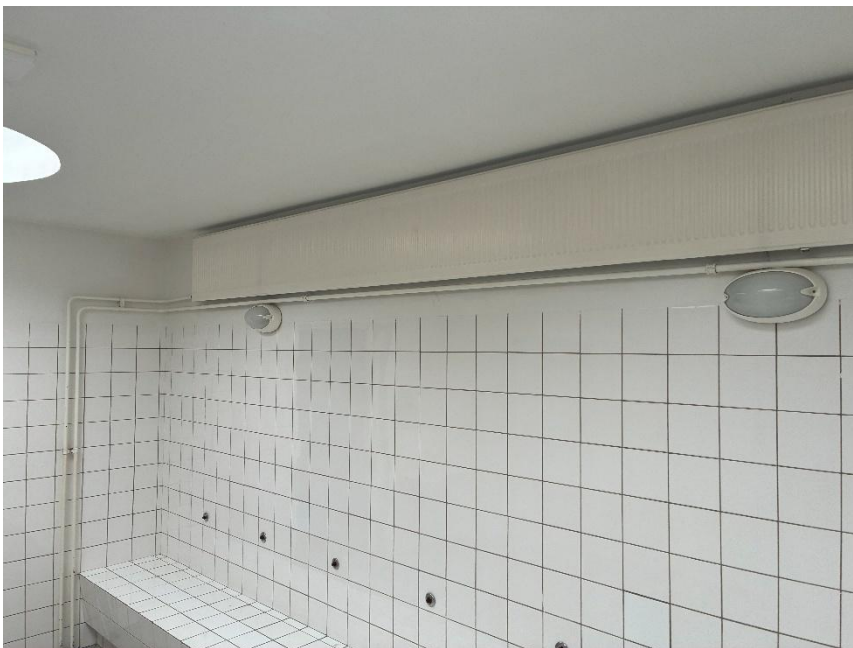
Foto 6: Overzichtsfoto 2 verlichting douches Gymzaal Wijnruitstraat
