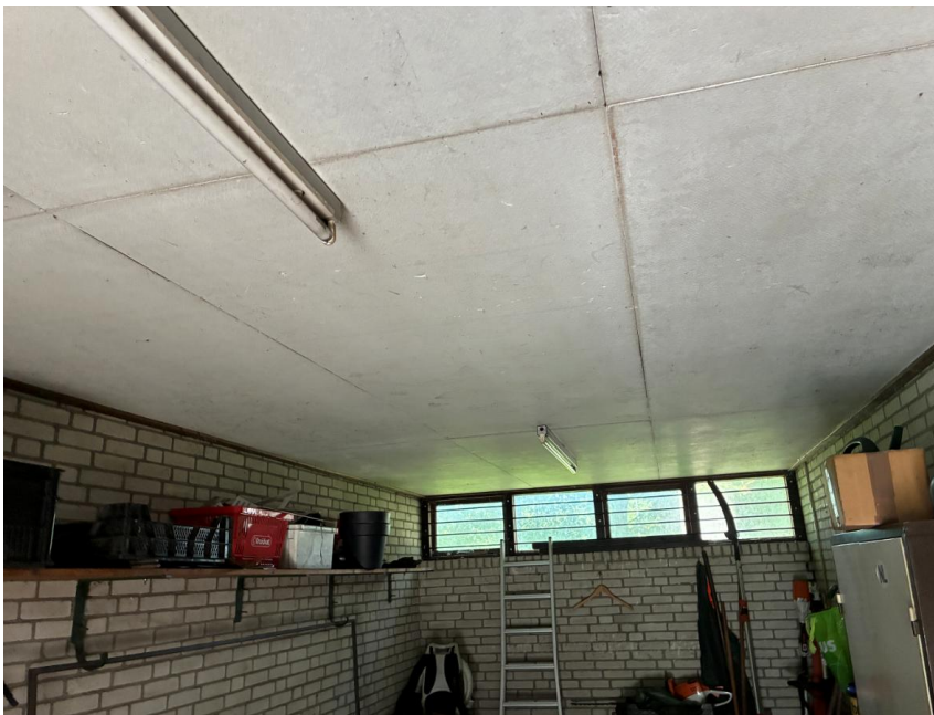
Foto 71: Overzichtsfoto van armaturen in berging Dienstgebouw begraafplaats Waalwijk
