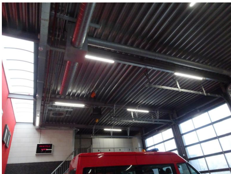
Foto 49: Overzichtsfoto van verlichting in remise Brandweerpost Sprang-Capelle
