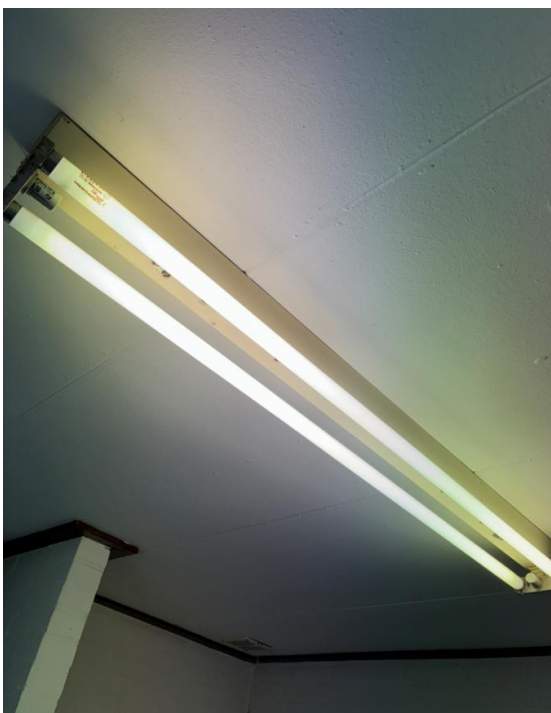
Foto 69: Overzichtsfoto van armatuur in schaftlokaal Dienstgebouw begraafplaats Waalwijk
