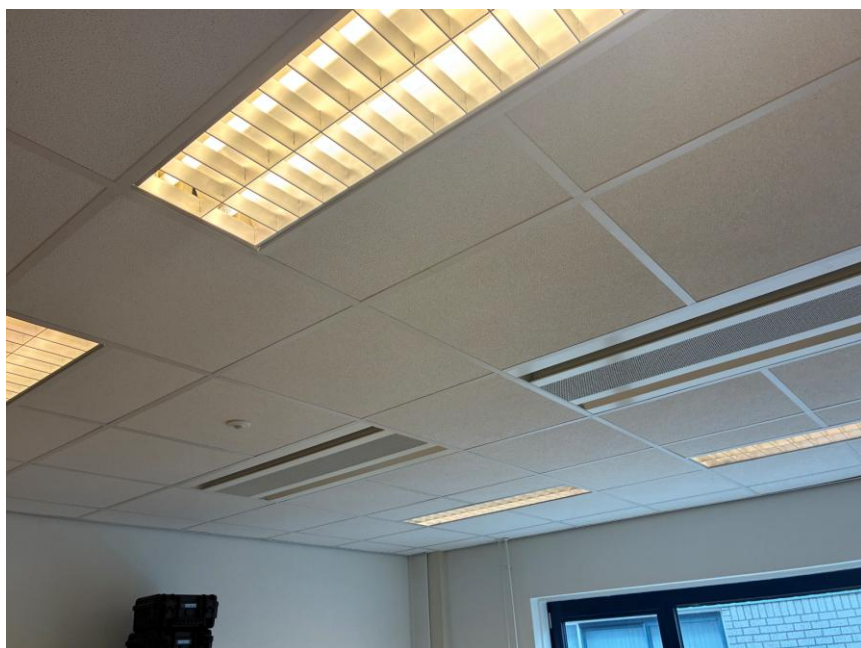
Foto 44: Overzichtsfoto van verlichting in kantoor/kantineruimte kantoor Gemeentewerf Waalwijk
