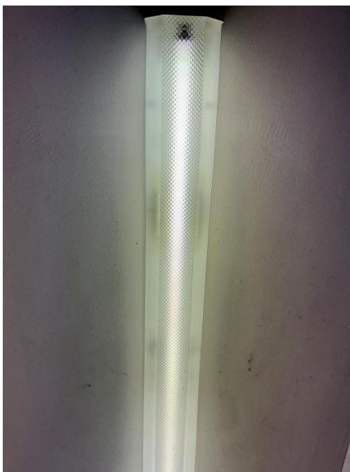
Foto 64: Detailfoto TI-armatuur in technische ruimte Aula begraafplaats Sprang
