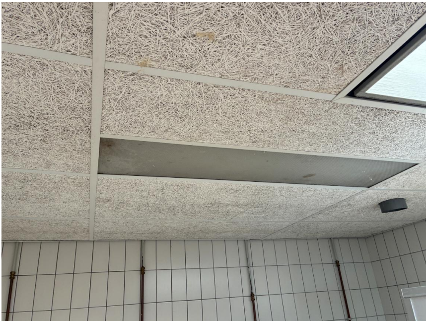
Foto 83: Foto van verlichting in toilet voor personeel Openluchtwembad Zidewinde
