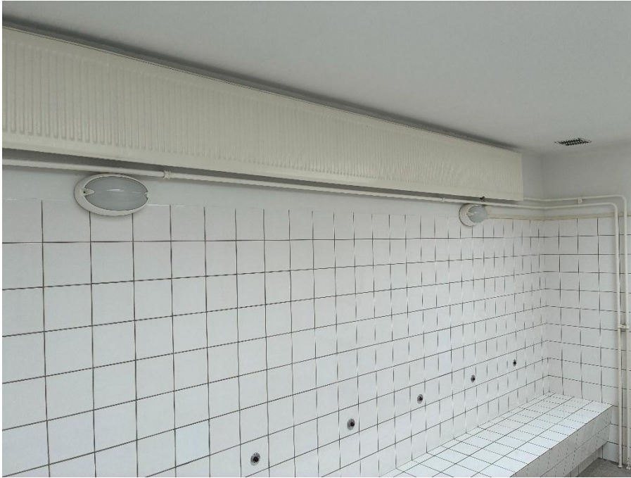
Foto 5: Overzichtsfoto 1 verlichting douches Gymzaal Wijnruitstraat
