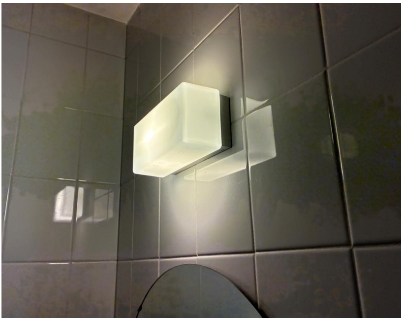
Foto 66: Detailfoto van armaturen boven spiegels in toiletten Aula begraafplaats Sprang
