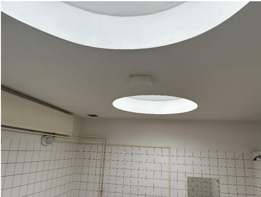
Foto 7: Foto 1 van gecombineerd noodverlichtingsarmatuur douches Gymzaal Wijnruitstraat
