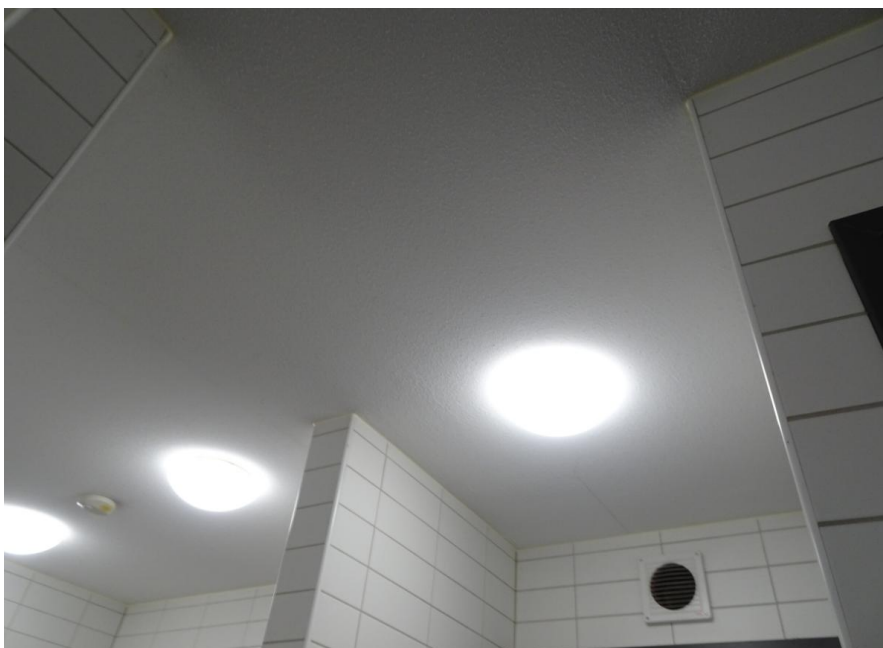
Foto 48: Overzichtsfoto van downlighters in sanitaire ruimtes Brandweerpost Sprang-Capelle
