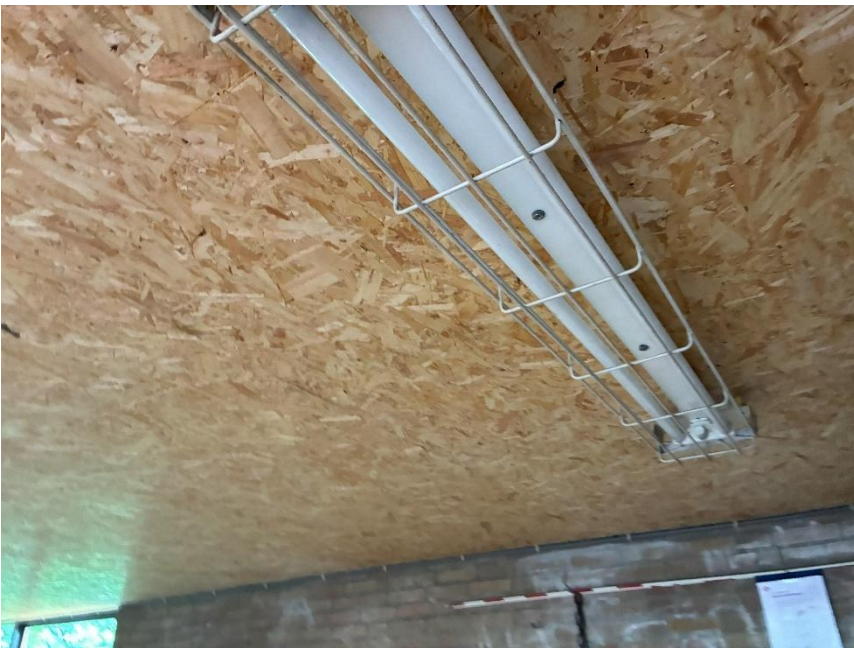
Foto 10: Detailfoto 2 van balvaste armaturen in toestellenberging Gymzaal Wijnruitstraat
