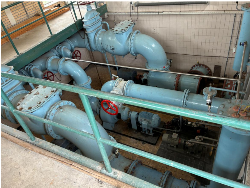
Foto 79: Foto van pompput aanwezig in pompruimte Sluis Waalwijk
