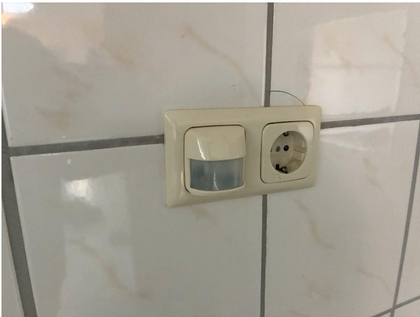
Foto 4: Aanwezigheidssensor op wand in kleedruimtes Gymzaal Wijnruitstraat
