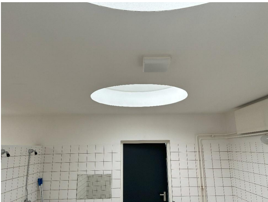
Foto 8: Foto 2 van gecombineerd noodverlichtingsarmatuur douches Gymzaal Wijnruitstraat
