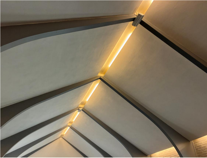
Foto 57: Overzichtsfoto 1 van armaturen boven verlaagd plafond Aula begraafplaats Sprang
