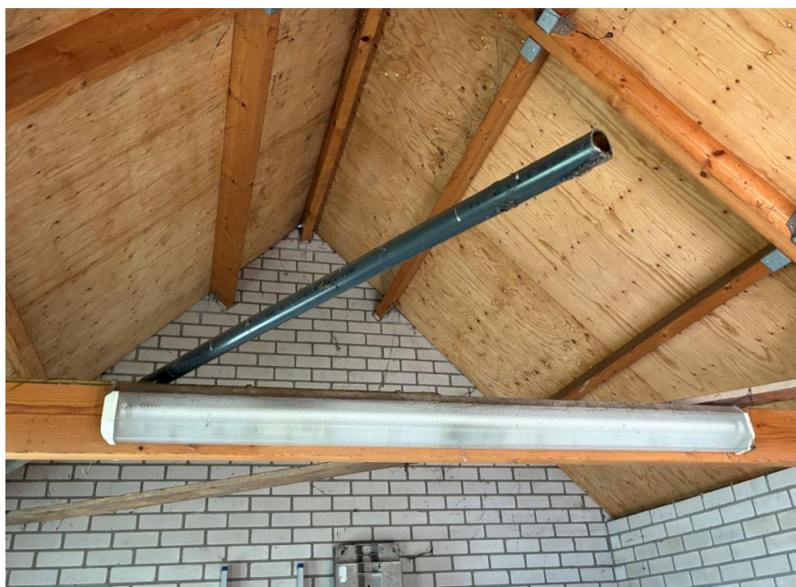
Foto 67: Overzichtsfoto van armatuur in berging Aula begraafplaats Sprang
