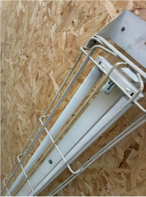
Foto 9: Detailfoto 1 van balvaste armaturen in toestellenberging Gymzaal Wijnruitstraat
