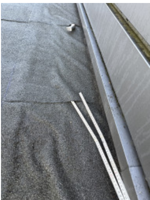
Lage dak links achter twee lekkages
