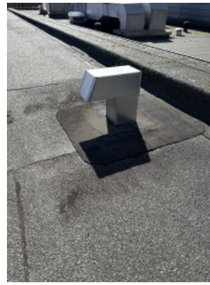
Hoge dak voor kabeldoorvoer
