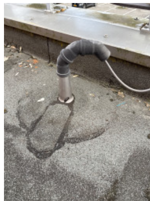
Lage dak links voor kabeldoorvoer
