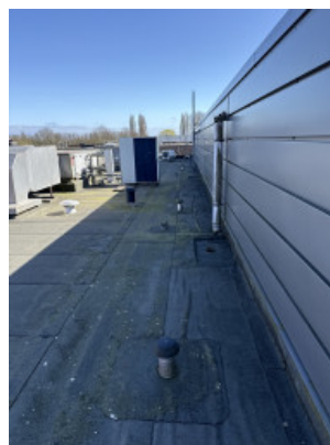
Hoge tussendak schoon
