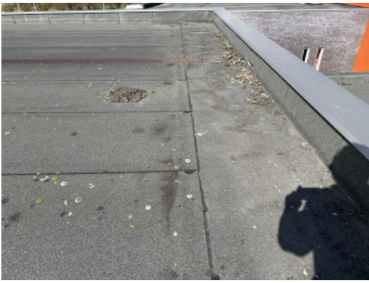
Hoge dak links achter vuil
