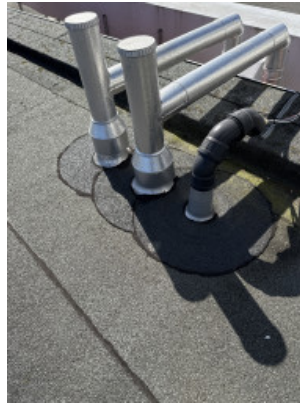
Hoge dak voor leiding en kabeldoorvoeren
