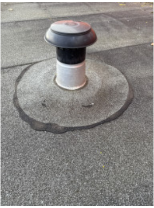
Lage dak links voor ontluchting
