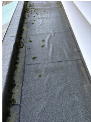
Lage dak rechts achter ploovorming
