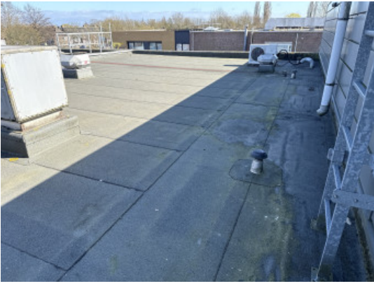
Hoge tussendak schoon
