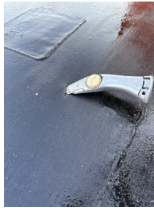
Lage dak rechts achter lekkage
