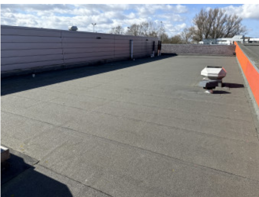
Hoge tussendak schoon
