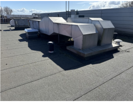
Hoge tussendak luchtbehandelingsunit
