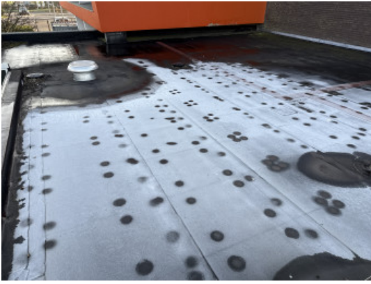
Lage dak rechts achter
