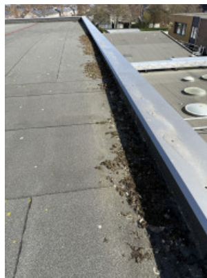
Hoge dak links achter vuil
