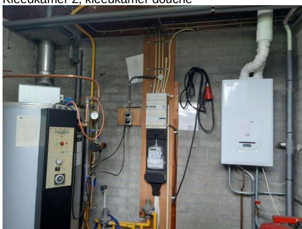
Kleedkamer 2, techniek ruimte
