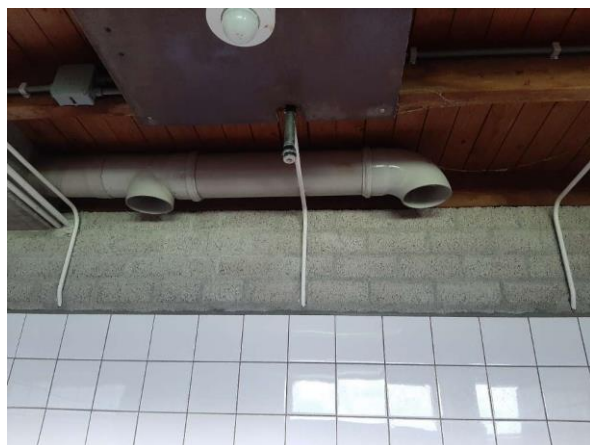
Kleedkamer 2, kleedkamer douche ontluchting pvc
