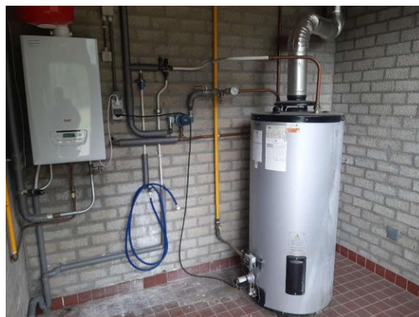
Kleedkamer 2, techniek ruimte 2
