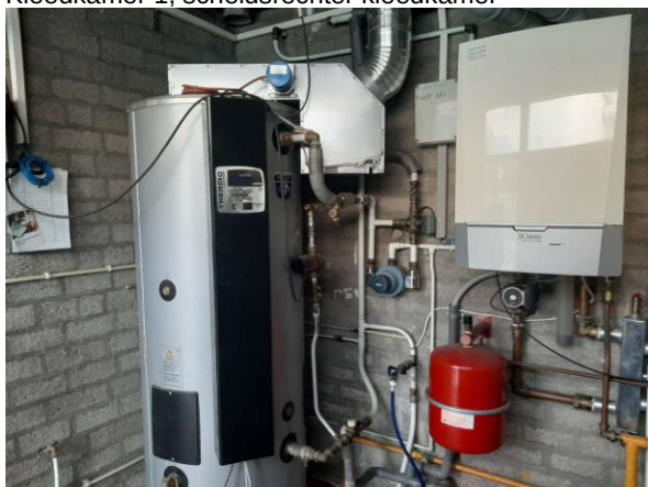
Kleedkamer 1, techniek ruimte
