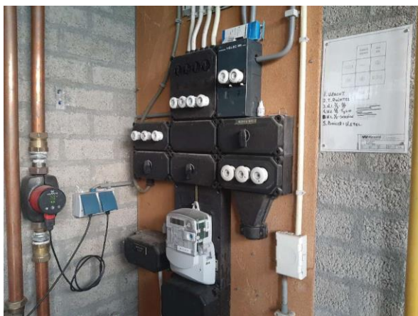
Kleedkamer 1, techniek ruimte meterkast
