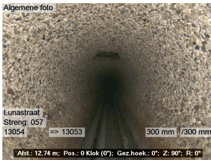
Figuur 5.5 Voorbeeld ingrijpmaatstaf: BAF Klasse 4EC – Opp. Schade, ontbrekende toeslagstoffen, chem., boven waterpeil.
