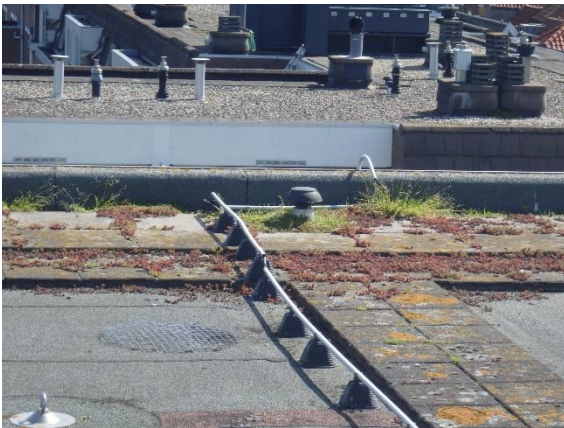
27: aanwezige installatie bliksembeveiliging
