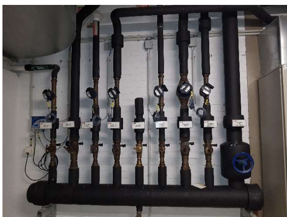
Leveringspunt gebouw D
