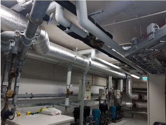
Leveringspunt gebouw H
