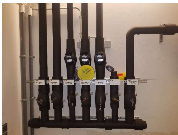
Leveringspunt gebouw G
