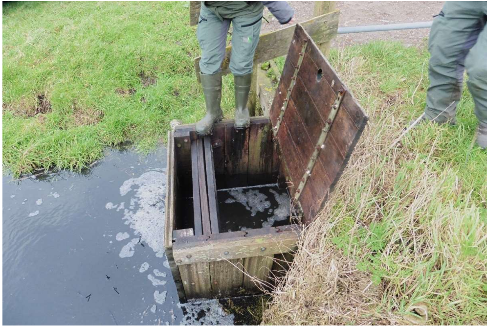
Centrale in- en uitlaat van peilvak 3 (nabij weg) geheel te herzien.
