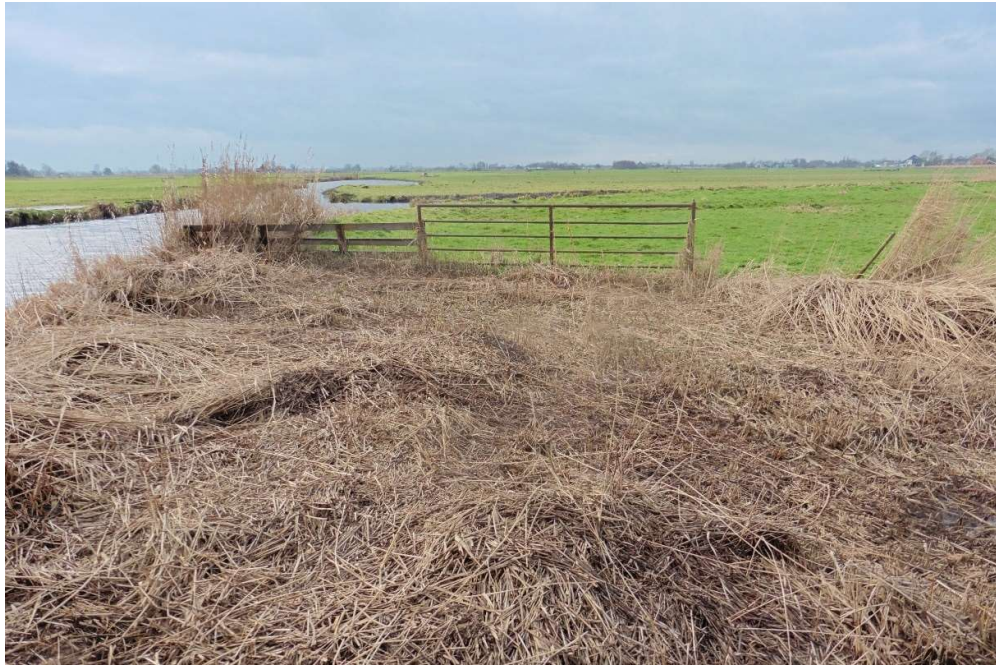
Locatie inlaat nabij (te vervangen) hekwerk. Op de voorgrond te herstellen kade.
