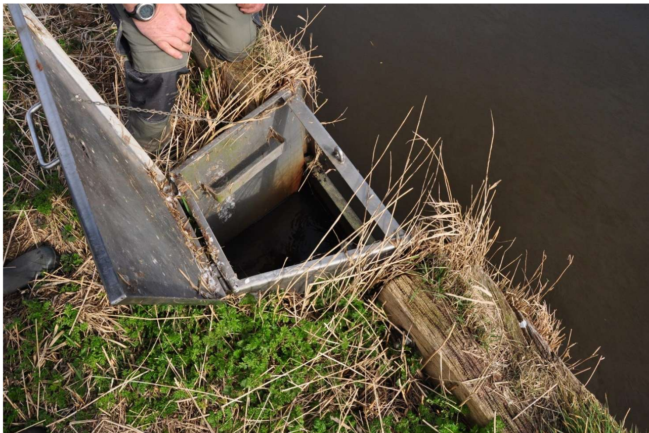
M13, overstortpunt en duiker. Te vervangen.
