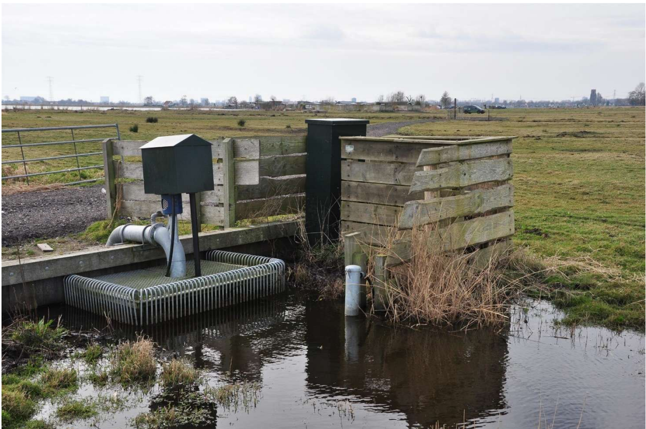
M02, Bestaande VOPO pomp (uitlaat peilvak 1 en 2a), te verbeteren incl. onderhoud.
