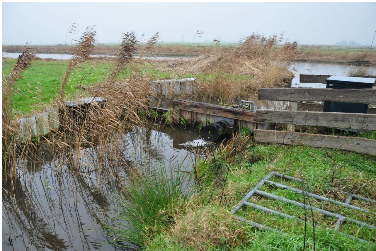
M10, bestaande inlaat. Te verwijderen en nieuwe inlaatconstructie aanbrengen.
