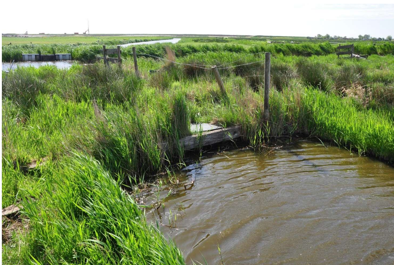
M04, Bestaande stuwput met sifon. Te vervangen en onderhoud sifon.
