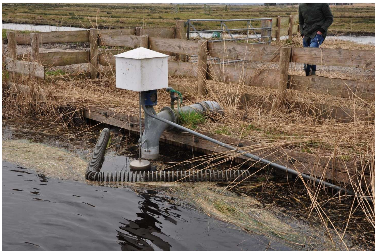
M03, Bestaande VOPO pomp (uitlaat peilvak 1 en 2a), te verbeteren incl. onderhoud.
