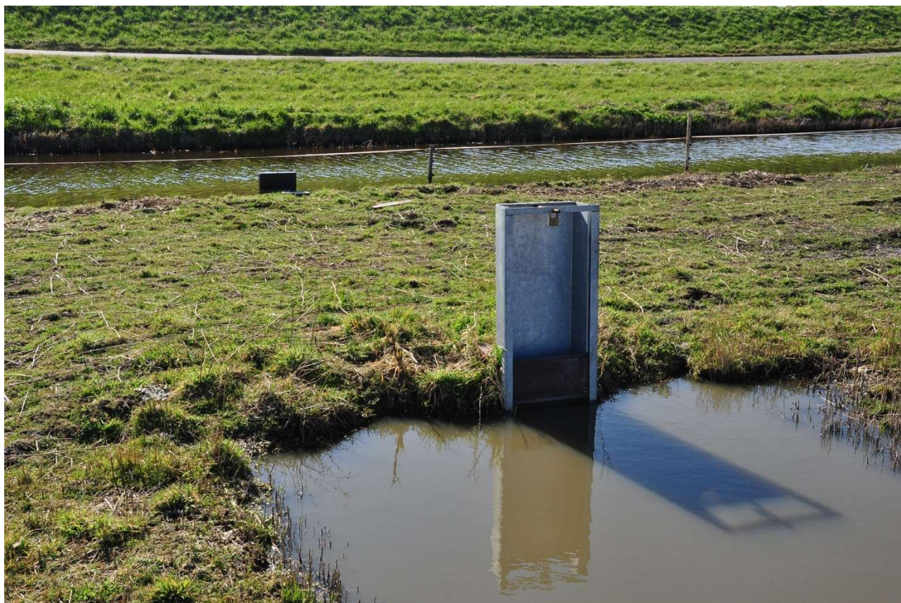
K04, bestaande duiker met overstortput (te vervangen en veranderen)
