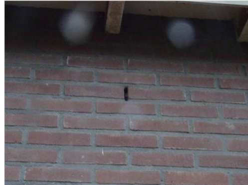
Figuur 4.3 Open stootvoeg aan noordzijde van de onderzoekslocatie.
