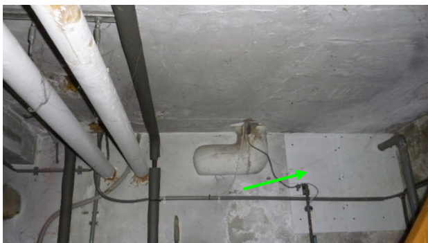
Foto 15: Moderne brandwerende beplating in de cv-ruimte (onverdacht), op meerdere locaties in het pand aanwezig.
