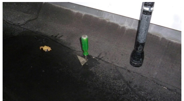
Foto 20: Het isolatiepakket op het platte dak van Bouwdeel '57 is te dik voor een goede inspectie bij slecht weer.
