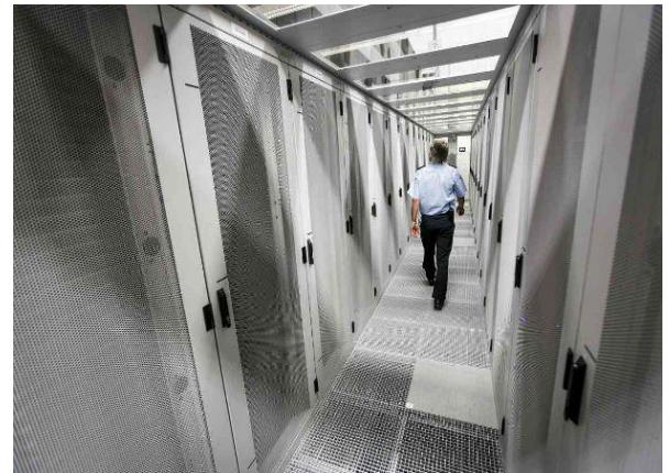
Een koude gang in ODC Belastingdienst
