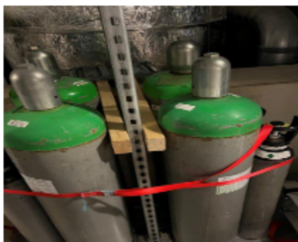
Opslag technische ruimte - cilinders
