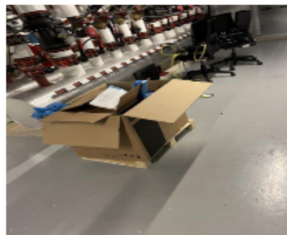
Opslag technische ruimte Helix
