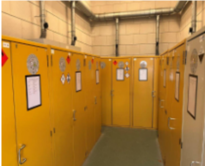
Gevaarlijke stoffen opslag extern gebouw
