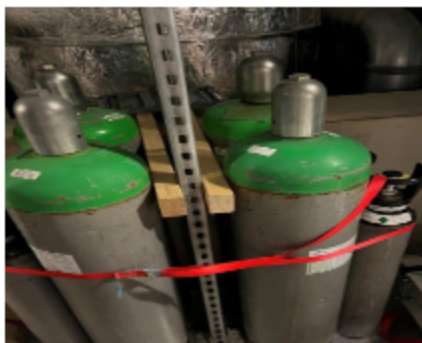
Opslag technische ruimte Helix
