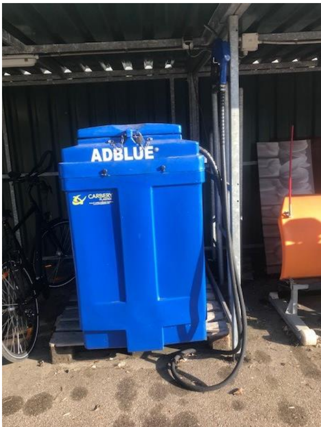
Foto 5. AdBlue bulk tank locatie Wilnis
