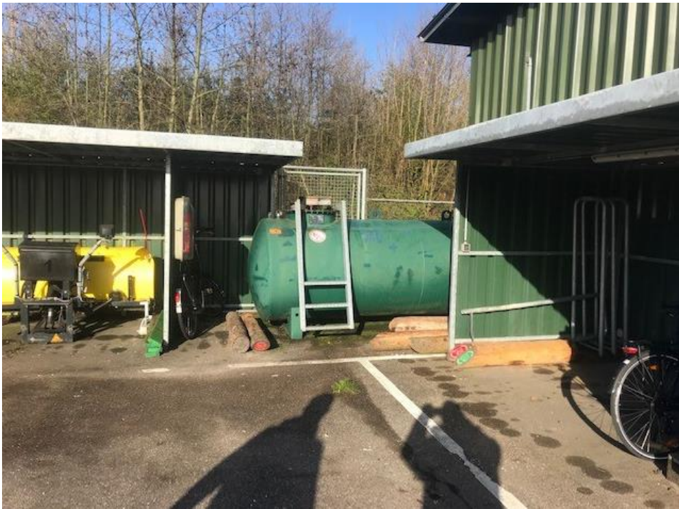
Foto 4. Bulk tank locatie Wilnis
