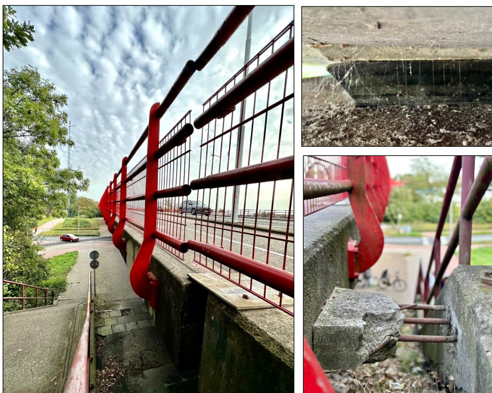
Figuur 12 - Deformatie aanbrug Zwijndrechtzijde
