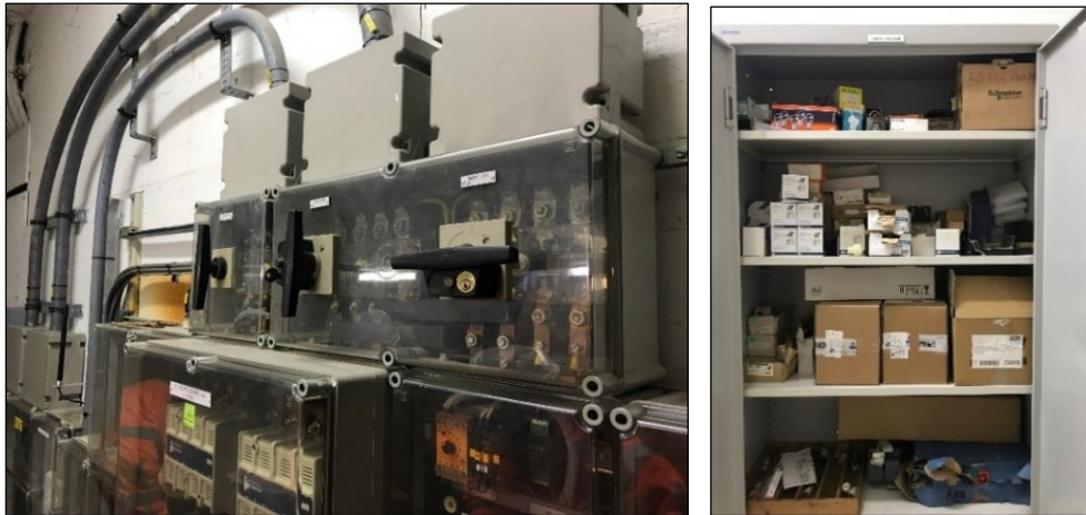
Figuur 18 - Impressie elektrische installaties
