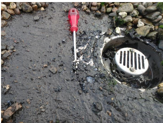
Foto 15 Slechte conditie van plakstuk hemelwaterafvoer.
