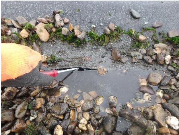
Foto 7 Onthechting opstandstrook van dakbedekking in het vlak.
