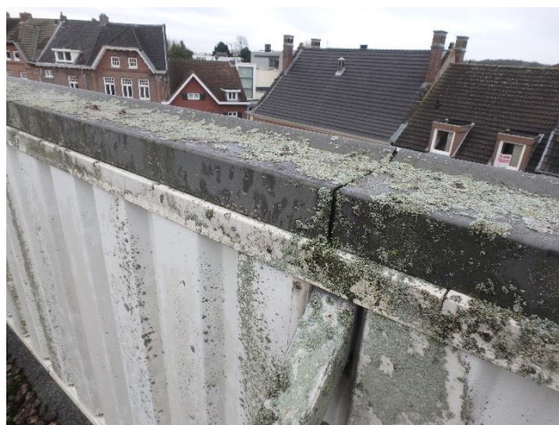
Foto 4 Korstmossen op randafwerking.
