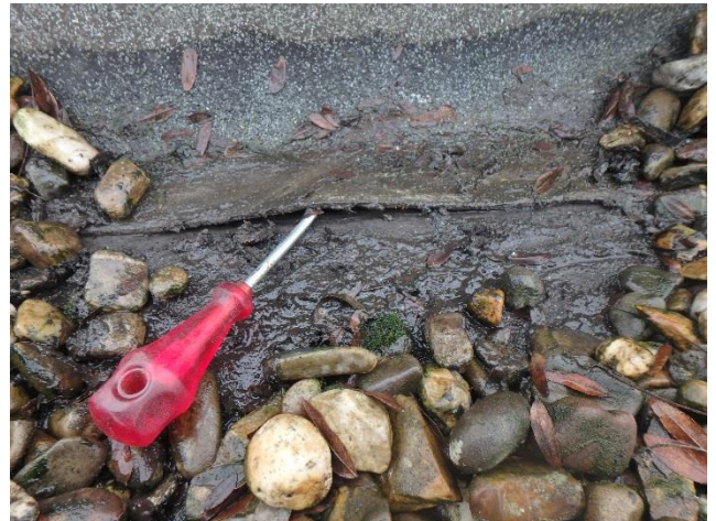
Foto 10 Onthechting randstrook van dakbedekking in het vlak.
