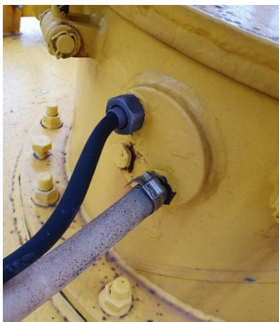
Afbeelding 13: Kabeldoorvoer en ontluhtingslang.
