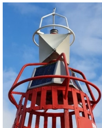
Afbeelding 1: Bovendeel van dagmerk van lichtboei met daarboven oude elektrische installatie.
