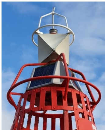
Foto 1: Bovendeel van dagmerk van lichtboei met daarboven oude elektrische installatie.
