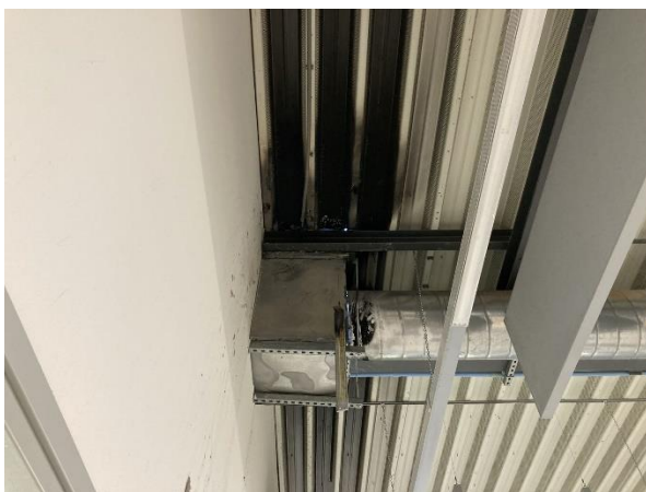
Het motorcompartiment aan de binnenzijde
