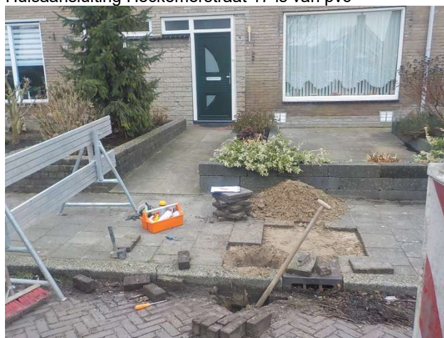
Kolk aansluiting ter hoogte van Floris van Alkemadestraat 18 is van pvc
