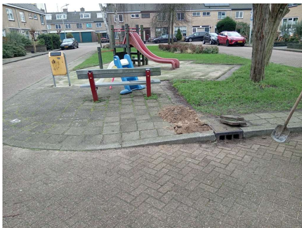
Kolkaansluiting in de Heckemerstraat is van pvc
