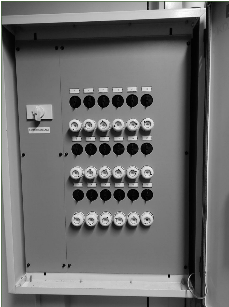
Foto 1. Bestaande verdeelinrichting D1-1.
