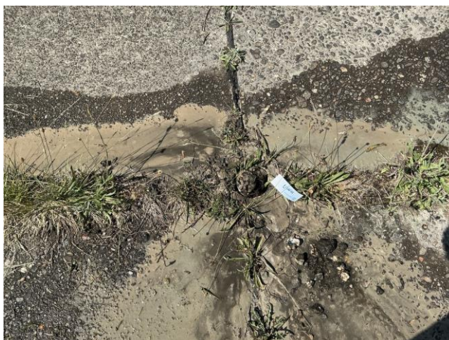
Aan de onderzijde boorkernen geen scheurinleiders aangetroffen
