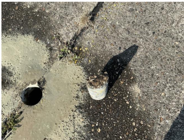
Aan de onderzijde boorkernen geen scheurinleiders aangetroffen
