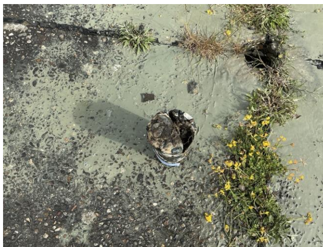
Aan de onderzijde boorkernen geen scheurinleiders aangetroffen
