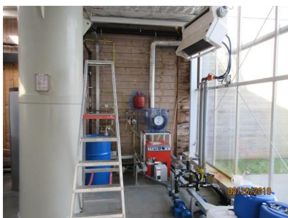
Een proef- en onderzoekopstelling van een biogasinstallatie in gebouw 8 met verwarmingsinstallatie.
