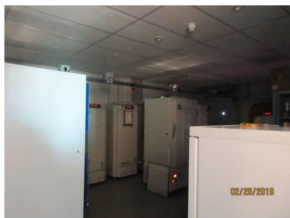
Gebouw 1: klimaat- en koelkasten.
