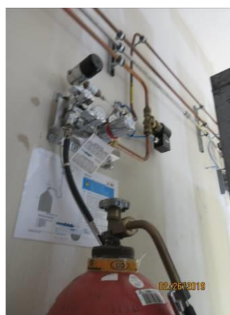
Brandbare gassen ook gekoppeld aan een leidingnet.
