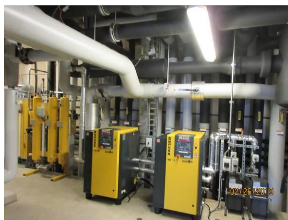
Gebouw 4: inkijk in een gedeelte van de stookruimte.
