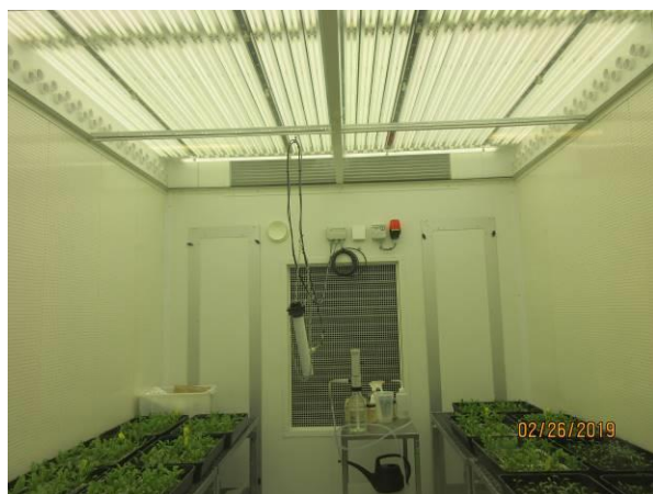
Gebouw 7: inkijk in een van de klimaatcellen.
