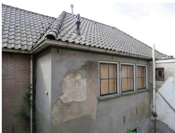
19: Linker zijgevel die geheel is gepleisterd. In het pleisterwerk zijn verschillende bouwfasen en herstellingen herkenbaar.
