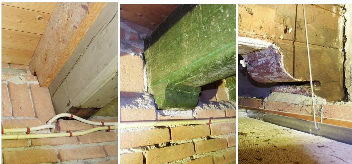
28: Balkopleggingen. Links een oplegging met uitsparing, waarin waarschijnlijk een console aanwezig was. In het midden een oplegging met een console, waarvan het onderste gedeelte blijkt te zijn verwijderd. Rechts een volledige console in het plafond van de tweede bouwlaag.
