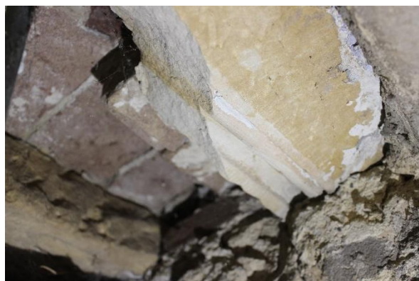
27: Gedeelte van de zandstenen latei, waarin profileringen met een waterhol zijn aangebracht.
