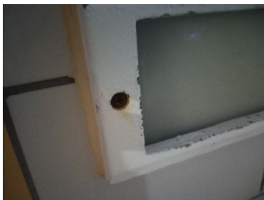
5.1i lichtarmaturen (N233)
