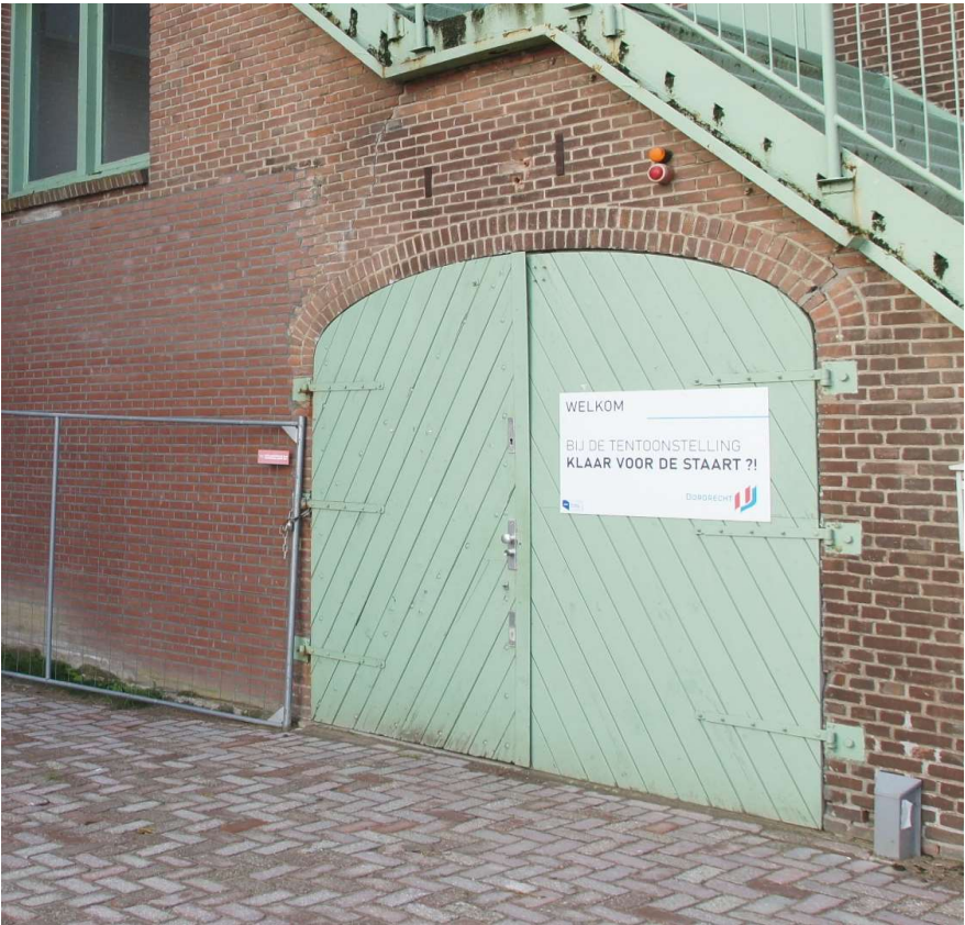
Boven, houten poortdeuren. Linkerpoortdeur onderkant slecht door optrekkend vocht
