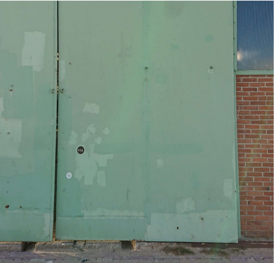
Boven, stalen schuifdeur westgevel ter hoogte as 5. Onderdeel laat los en roest
