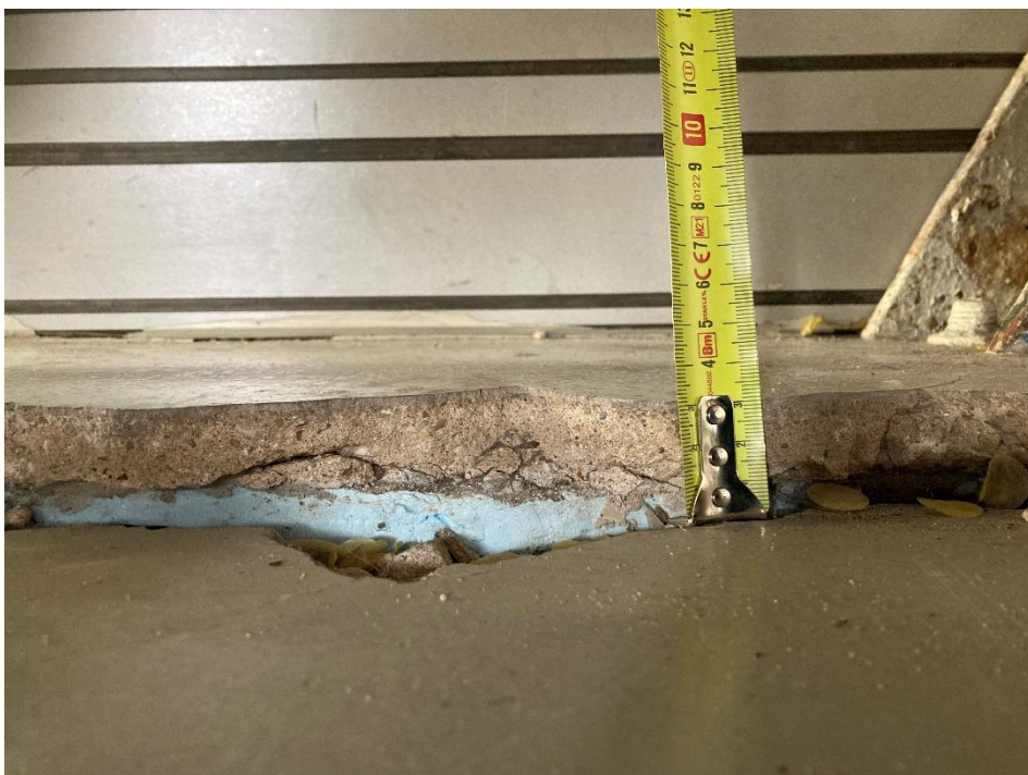
Foto 1716: Scheurvorming en verzakking van de bouwkundige vloer (hier t.p.v. as D/14, net buiten de scope)
