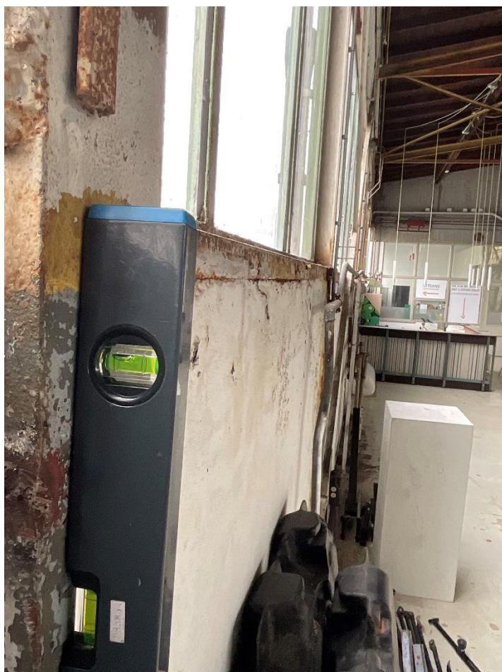
Foto 1364: As E (zijgevel) staat niet waterpas
