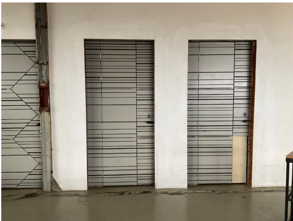
Foto 1392: Scheuren en verzakkingen in de vloer voor de toiletten
