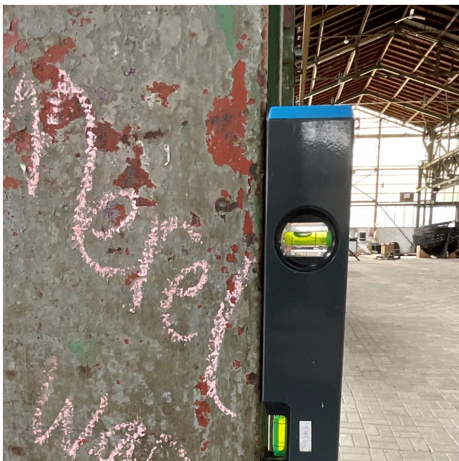
Foto 1287: Een aantal kolommen op stramien B staat niet helemaal waterpas
