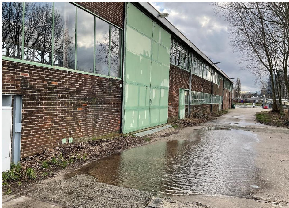
Foto 1433: Wateroverlast naast de zijgevel, t.p.v. de entree / vluchtroute
