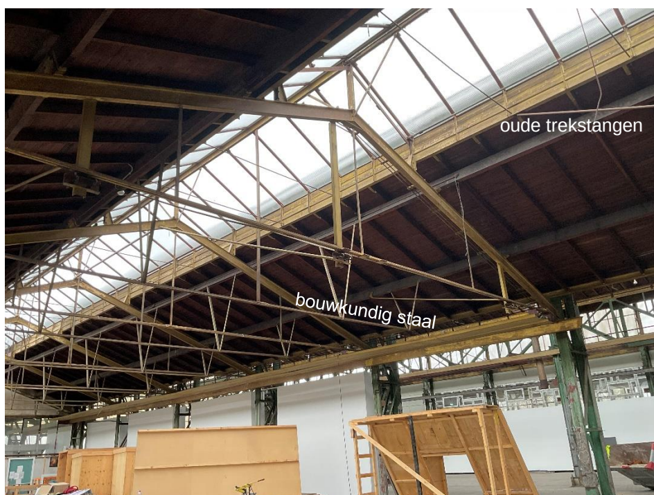
Foto 1251: Oude trekstangen (eerste spant op de foto) en bouwkundig staal (d.m.v. V ondersteund)
