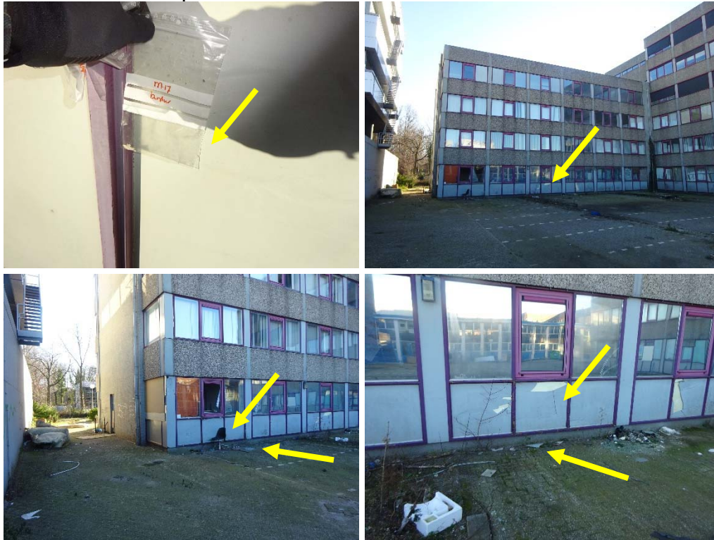
Foto 5: Sandwichpanelen in de kozijnen op de begane grond ( niet asbesthoudend / zie M-17 + M-24). Op diverse plaatsen zijn ze stuk en liggen dan losse stukken op het maaiveld.
