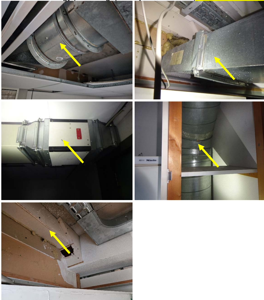
Foto 7: Ontluchtingskanalen zijn aangebracht in 1994. Hier zijn dan ook new technology plaat toegepast bij diverse units ( niet asbestverdacht )
