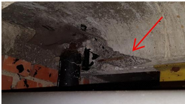
Zeer plaatselijke schade bij leidingdoorvoer.
