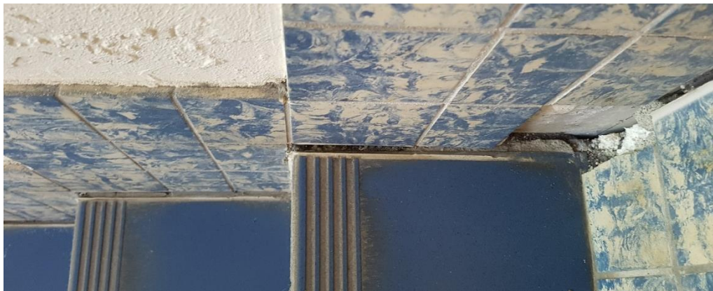
Scheuren in bouwkundige afwerking t.p.v. dilatatie in het trappenhuis
