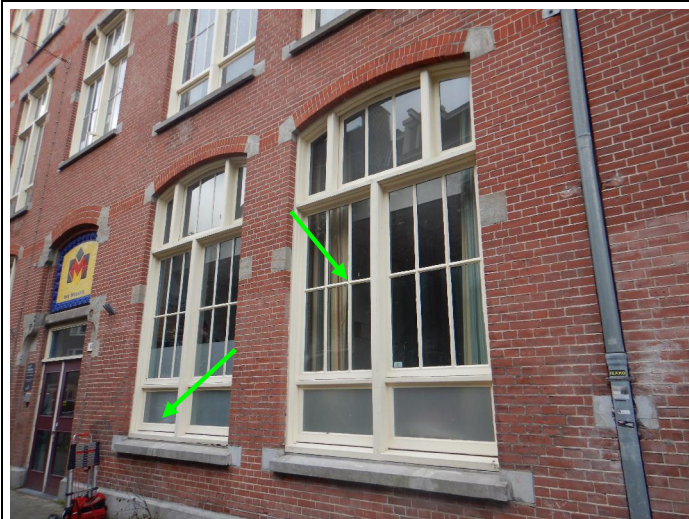
Foto 16: Asbestvrije stopverf in vast raam en klampaam begane grond (1-8: M08a-V en M08b-V, 1-9: M09a-V en M09b-V)
