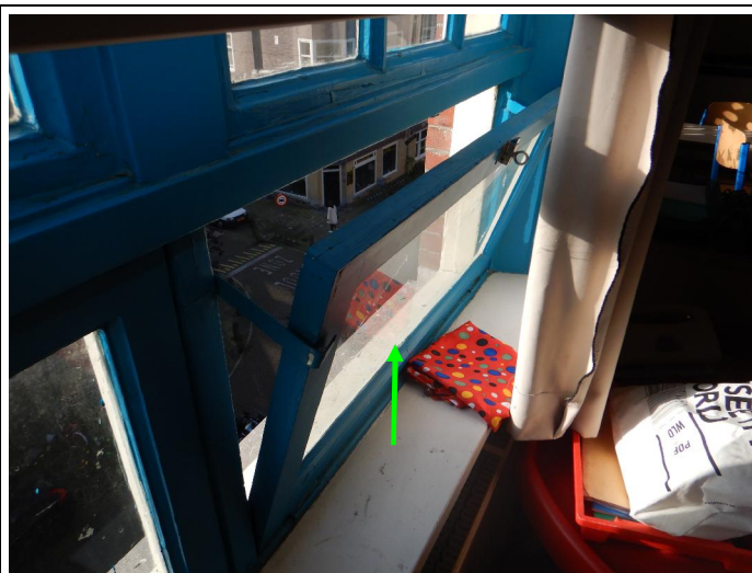
Foto 1: Asbestvrije stopverf in klampaam op 2 e verdieping (1-1: M01a-V en M01b-V)
