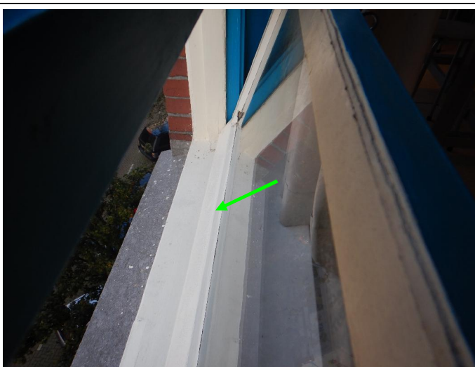
Foto 2: Asbestvrije stopverf in klampaam op 2 e verdieping (1-1: M01a-V en M01b-V)
