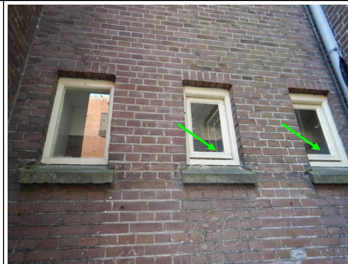
Foto 12: Asbestvrije stopverf in toiletraam begane grond (1-6: M06-V)
