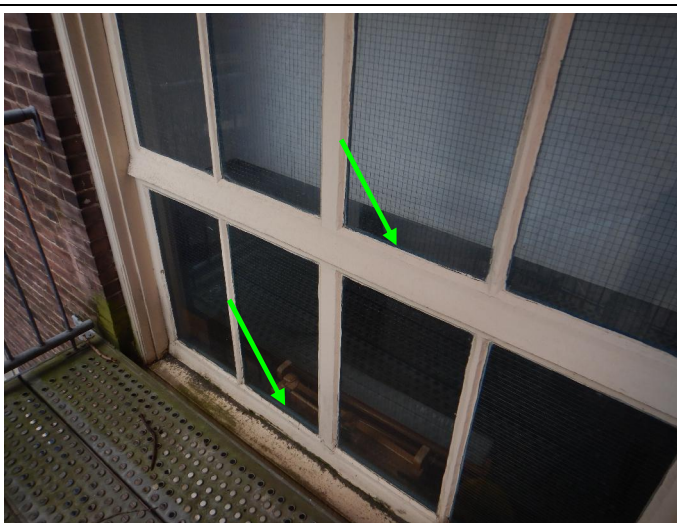
Foto 14: Asbestvrije stopverf in kozijnen noodtrap (1-7: M07a-V en M07b-V)
