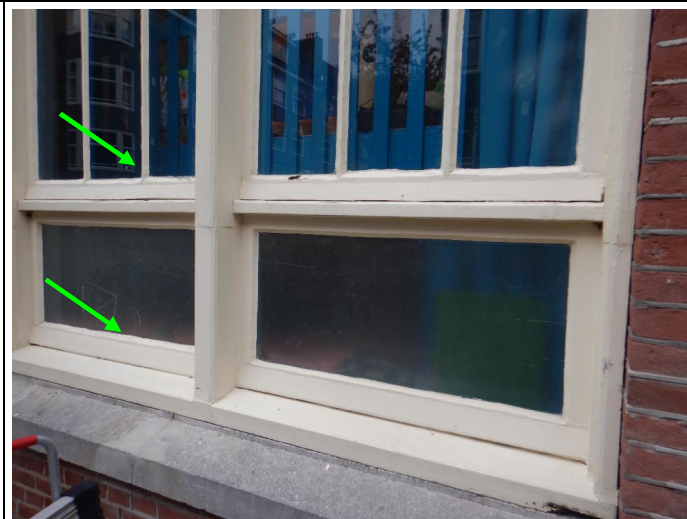
Foto 6: Asbestvrije stopverf in klampaam en vast raam op 1 e verdieping (1-3: M03a-V en M03b-V, 1-4: M04a-V en M04b-V)
