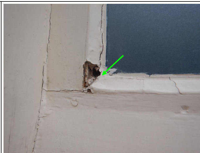
Foto 15: Asbestvrije stopverf in kozijnen noodtrap (1-7: M07a-V en M07b-V)
