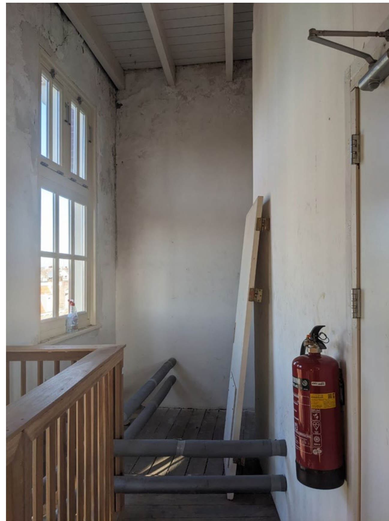
Gevel trapdeel en platdak Vocht vlekken zijn oud en inmiddels droog en de lekkage is eerder opgelost.
