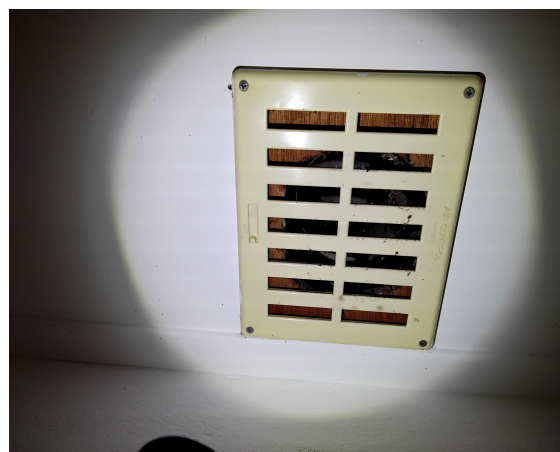
ontluchting in het toilet van pvc
