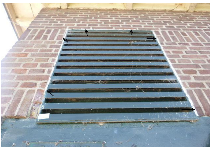
Asbesthoudende kit langs ventilatierooster.
