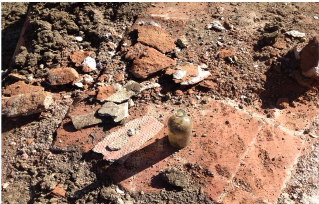
foto 01 asbest rondom molenfundering
