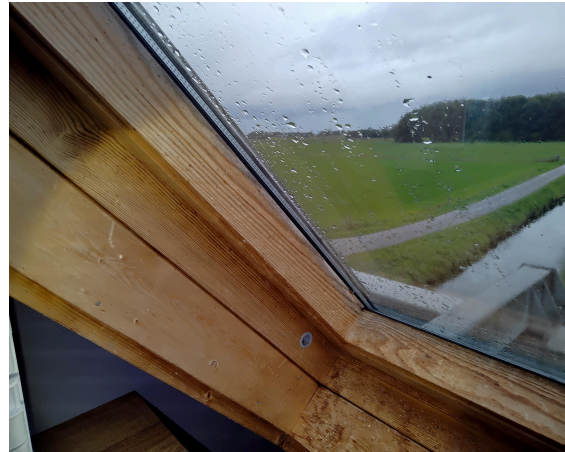
dubbelglas met rubbers in het dakraam.
