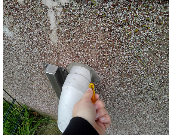
kit rondom doorvoer is niet asbestverdacht.
