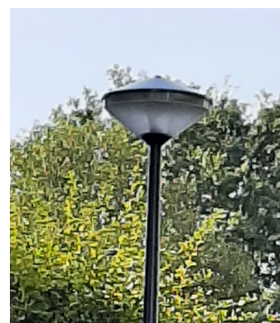
Kegel KFK van Lightronics als standaardmodel voor de Mantel en het Bio SciencePark. Mast en armatuur (mastvoet en kap) In RAL 7016
