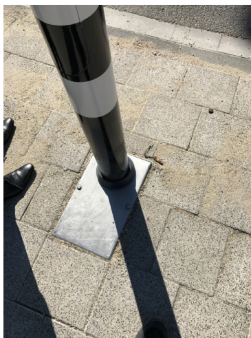
VRI mast in een Pipe-lock voorziening
