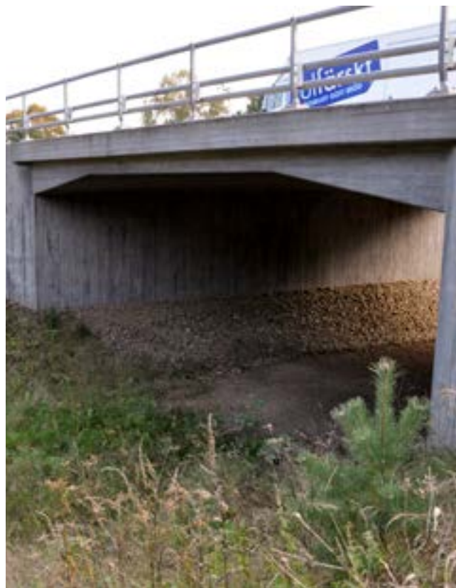
Grote faunatunnel (Bron: Dennis Wansink, Bureau Waardenburg)
