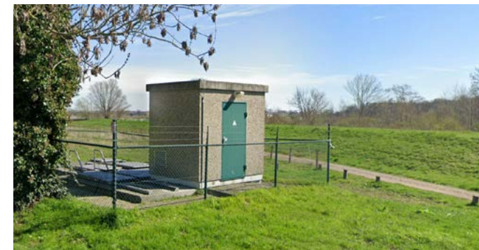
Figuur 131. Foto bestaand rioolgemaal; bron: google earth
