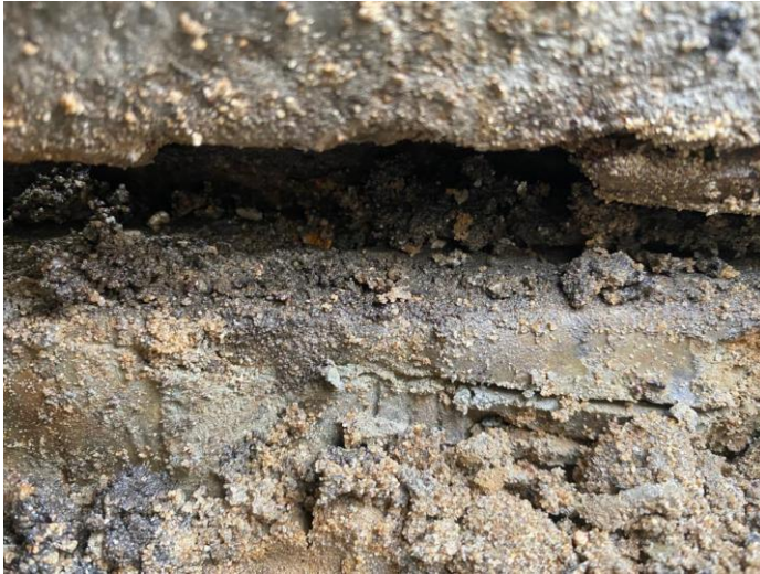
Aangeleverde foto - Tussen de buizen geen kit aangetroffen dus niet onderzocht
