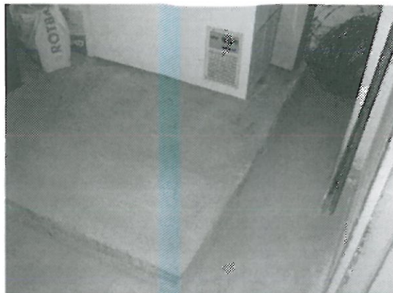
Foto 2, 3-Abm002, Golfplaat in stortvloer
