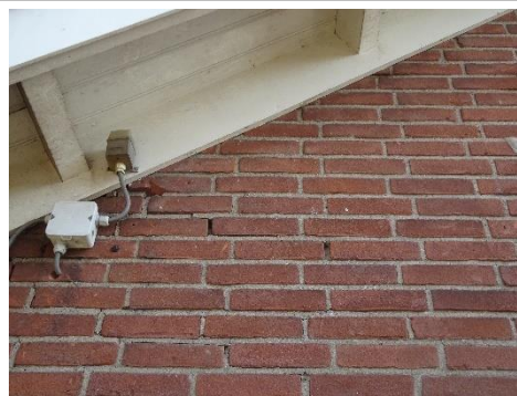
6. Verzand voegwerk en plaatselijke scheurvorming
