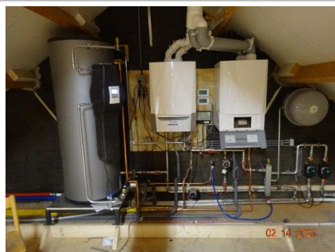
21. Boilers zolder + warmwateropslag
