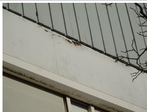
8. Delaminatie houten tussenpaneel
