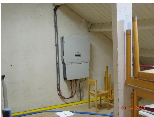
27. PV panelen omvormer
