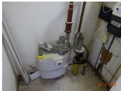
18. Hoofd gas meter
