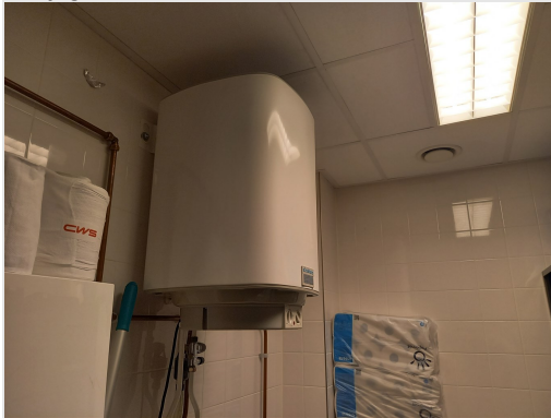
Boilers, niet verdacht
